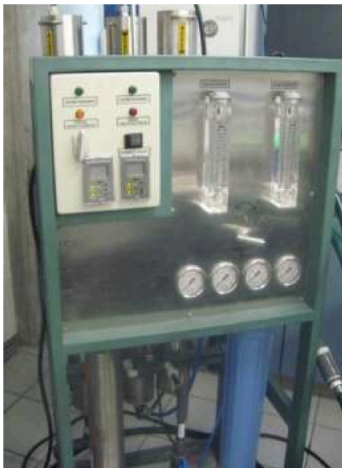
Figura 29. Módulo de membranas de nanofiltración operado.
