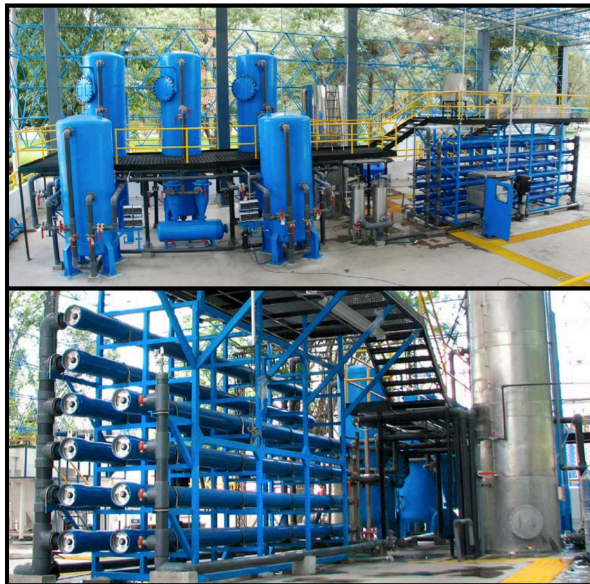
Figura 25. Tren de tratamiento avanzado y su módulo de ósmosis inversa. Fuente (SACM, 2011).
