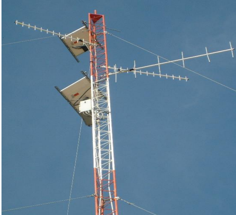
Figura 2.9 Aspecto de la torre donde instala en equipo de comunicaciones. Se observan 2 paneles solares y antenas de radiocomunicación.
