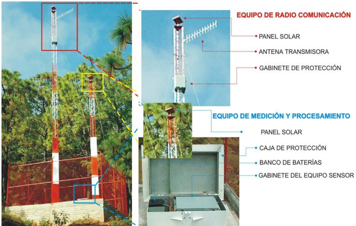
Figura 2.3. Aspecto general de una ESDECA típica
