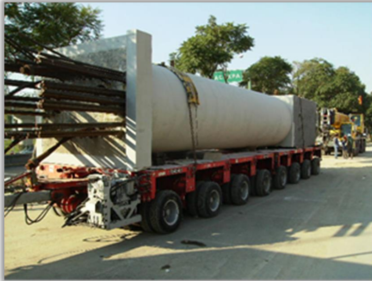
Figura 25. Columna prefabricada Fuente: Elaboración propia
