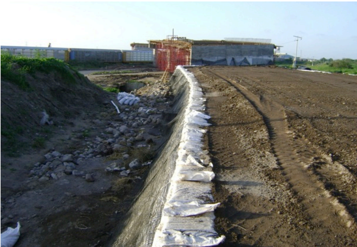
Fotografía A.4.4 Cimbra del terraplén a base de costales del mismo material de relleno.
