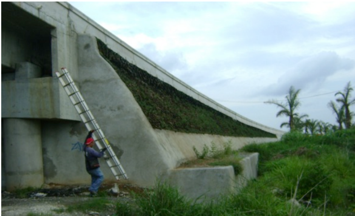
Fotografía A.4.8 Acabado del talud con vegetación a base de plantas de bajo mantenimiento y colocación de concreto con un espesor de 7.0 cm.
