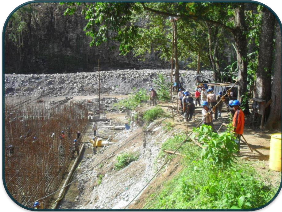
FOTOGRAFIA No.71.-Cuando la grúa se ocupaba se apoyaban del desnivel del almacén a la zapata para el traslado de este.
