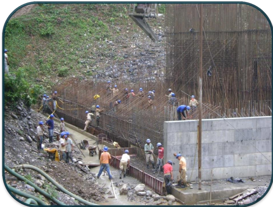
FOTOGRAFIA No.62.- En varias ocasiones se traslapaba el uso de la grúa torre pro lo cual nos auxiliábamos de las móviles y en muchos casos algún equipo tenia que esperar para que otro acabara.
