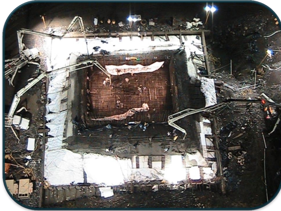
FOTOGRAFIA No.85.-Casi al término del colado se verificaron en los termopares que las temperaturas no rebasaran el gradiente en la temperatura de inicio y así asegurar el compuesto del concreto.
