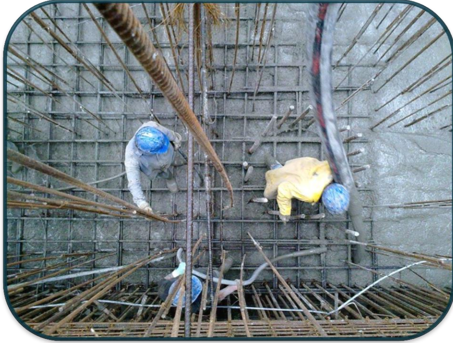
FOTOGRAFIA No.83.-En algunas partes de la zapata el volumen de acero permitía la maniobrabilidad de los equipos lo cual facilitaba muchas labores en el colado.
