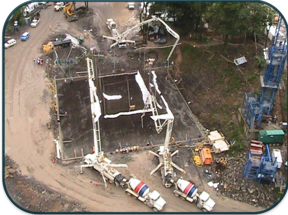
FOTOGRAFIA No.81.-El sentido de transito de las ollas permitió que ninguna bomba quedase sin suministro.
