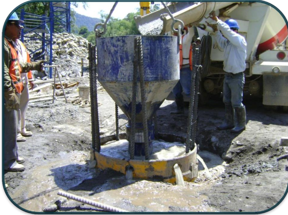
FOTOGRAFIA No.29.-El concreto va subiendo y desplaza toda las impurezas que aparezcan a lo largo del pilote.
