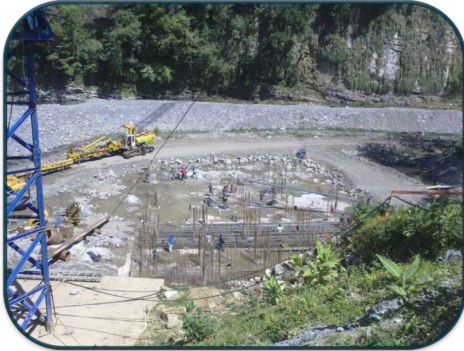
FOTOGRAFIA No.21.-Se necesito una coordinación metódica para la fabricación de los pilotes conforme se iban perforando.
