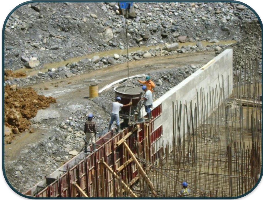
FOTOGRAFIA No.43.-Por medio de una olla portátil y la grúa torre se realizo el colado.
