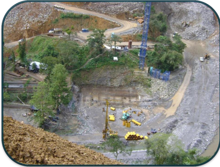
FOTOGRAFIA No.77.-Los trabajos constantes en la zapata resultaban casi un pilote completo al día (excavación, limpieza, armado , colado y descabece).
