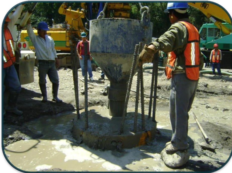
FOTOGRAFIA No.30.-Se puede ver a simple vista como sale de contaminado el concreto y como baja la calidad de este al principio.
