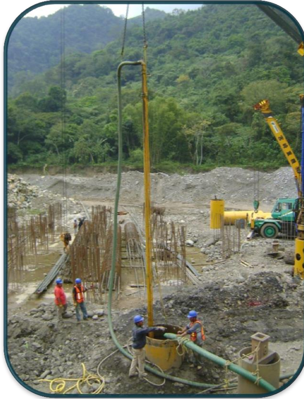
FOTOGRAFIA No.17.-Algunas veces se diseñaron tuberías a presión con aire para limpieza de arenas existentes
