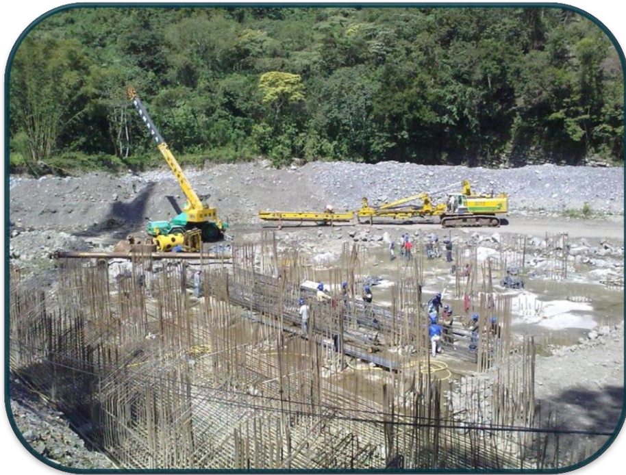
FOTOGRAFIA No.20.-Se utilizo el espacio de al zapata para el armado de los pilotes.
