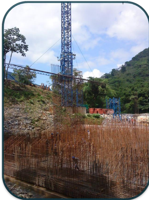
FOTOGRAFIA No.68.-El balancín que se diseño para cargar atados de varillas fue de gran apoyo.
