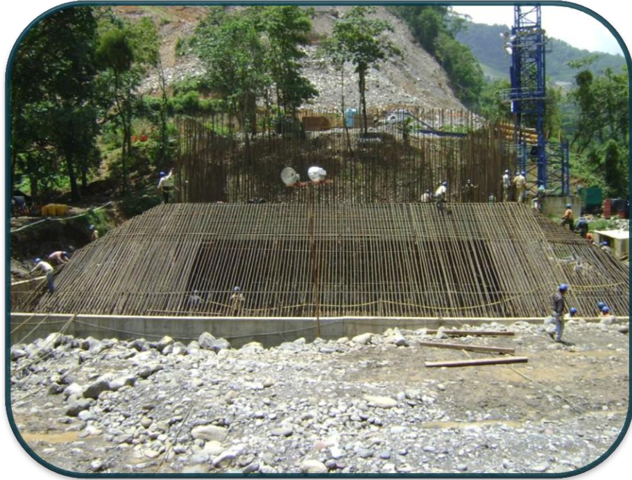
FOTOGRAFIA No.57.-Las varillas se movieron por medio de la grúa torre para mayor facilidad y movilidad.
