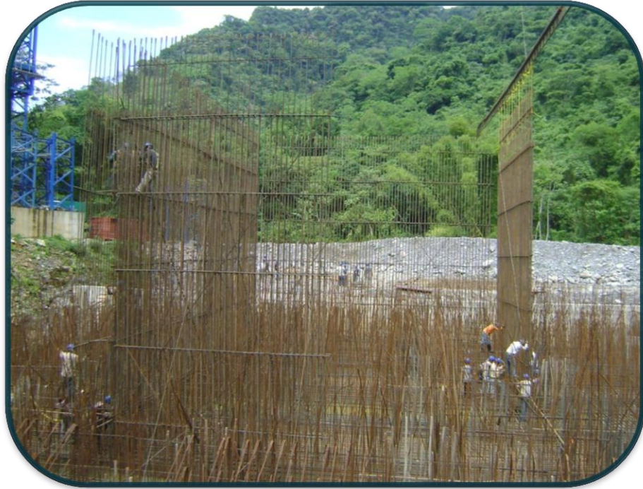
FOTOGRAFIA No.53.-Varios procesos se realizaron al mismo tiempo entre ellos la colocación de acero de la zapata.
