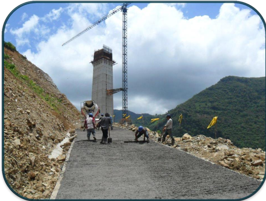
FOTOGRAFIA No.10.-Los colados de los caminos se realizaban los sábados para no estorbar a otros frentes que ocupaban estos accesos, o en algunas ocasiones en la semana por las tardes.
