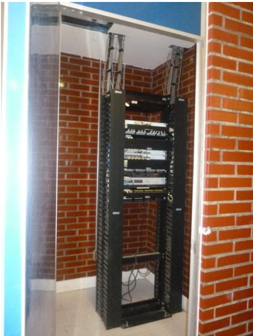
Figura 3.8. Cuarto de Telecomunicaciones Mediateca.
