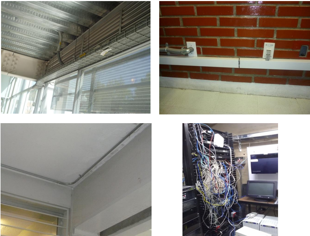
Figura 3.16. Cableado Horizontal canalizaciones.
