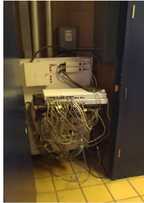
Figura 3.11. Cuarto de Telecomunicaciones Lace Física.
