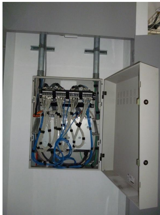
Figura 3.13. Cuarto de Telecomunicaciones Servicio Médico.
