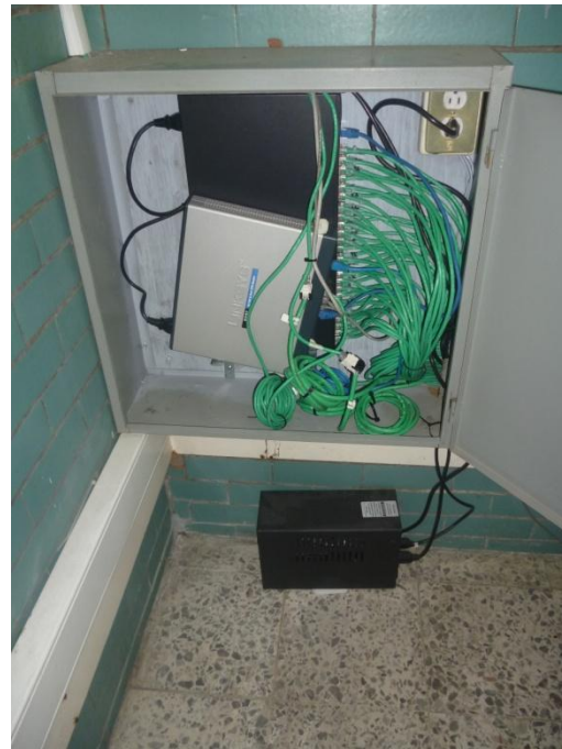
Figura 3.9. Cuarto de Telecomunicaciones Cómputo Fundación.
