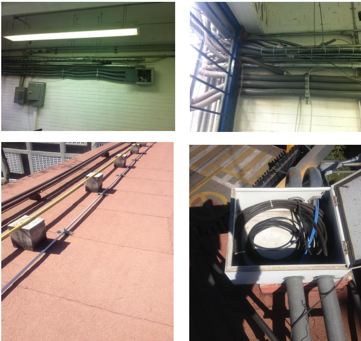
Figura 3.15. Canalizaciones de Backbone.
