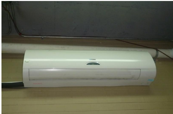
Figura 3.5 Equipo de aire acondicionado tipo minisplit.
