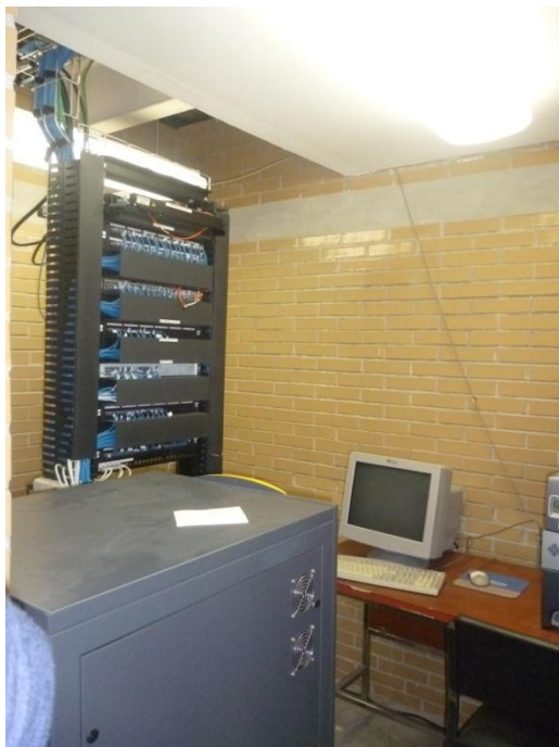
Figura 3.12. Cuarto de Telecomunicaciones Biblioteca.
