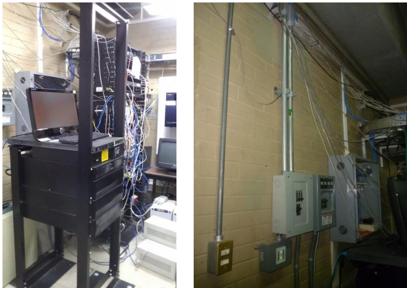
Figura 3.4. Sistema de alimentación ininterrumpida (UPS) y tableros eléctricos.
