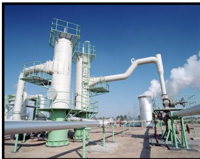
Figura 1. 8 Central geotermoeléctrica de Cerro Prieto 15 .
