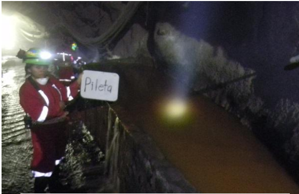
Figura 3-7 Pileta con derrame
