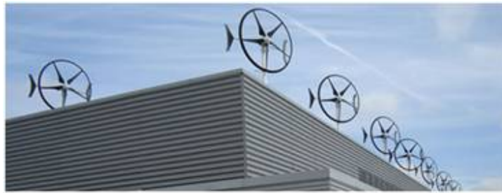
Figura 2.24 Aerogeneradores en cornisa
