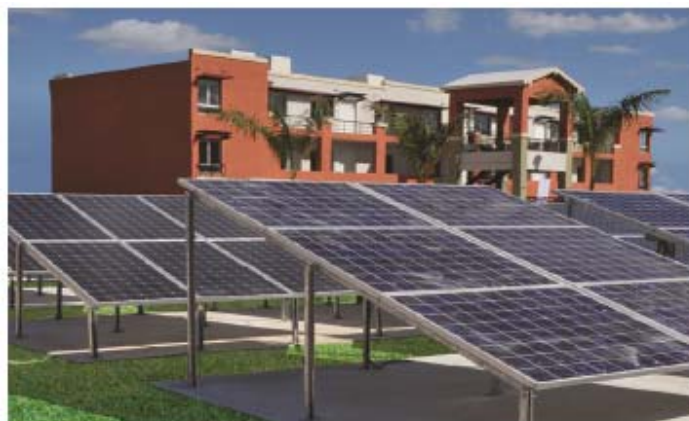
Figura 4.10 Granja Solar fotovoltaica implementada
