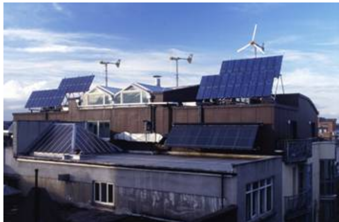
Figura 2.22 Cubierta con tres aerogeneradores
