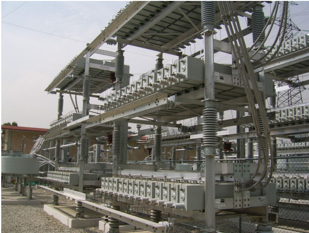
Figura 3.27.: Bancos de capacitores del TSC
