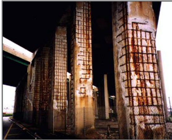
Fig. 3.5 Pérdida del recubrimiento del acero de refuerzo por la corrosión del mismo.
