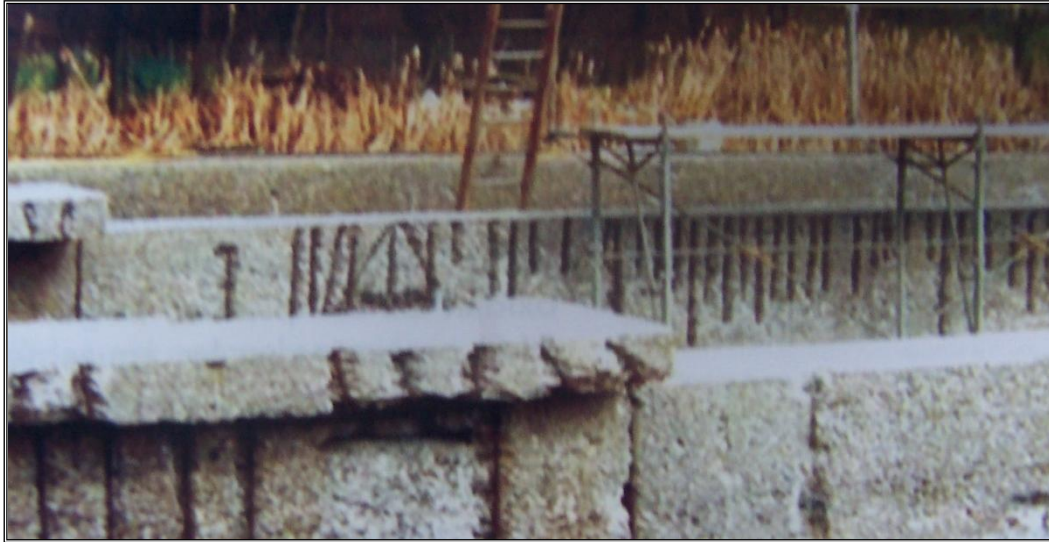
Fig. 4.4 Concreto armado afectado por la carbonatación
