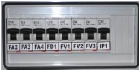
Imagen de los interruptores
