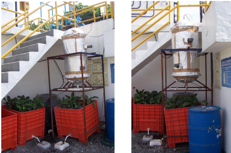
Figura 3.8 Fotografía del sistema de tratamiento
