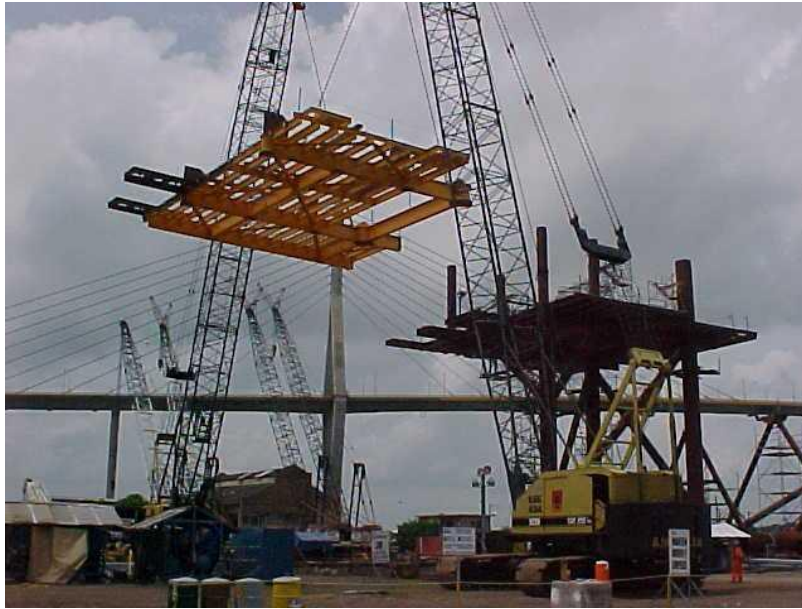
Ilustración 34. Desbalance en el izaje de la cubierta
