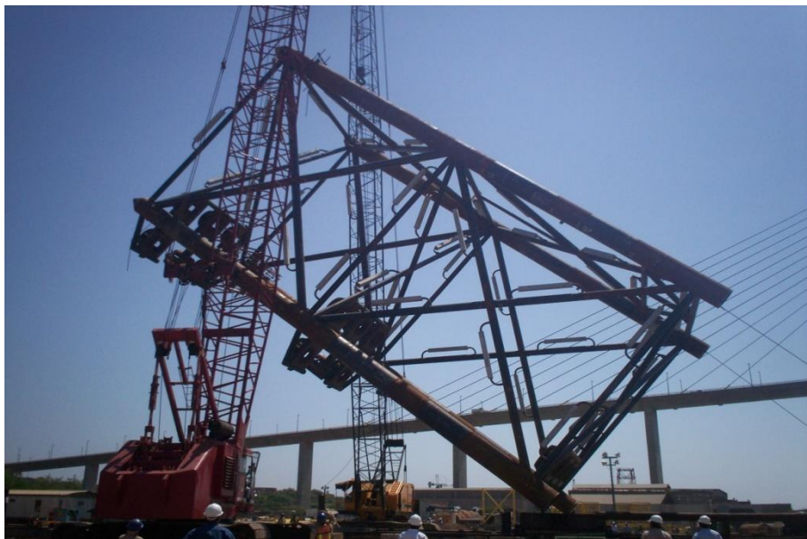
Ilustración 30. Intento de regresar la subestructura a su posición inicial
