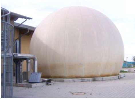
Figura 3.11 Membrana instalada para almacenar biogás excedente [5].
