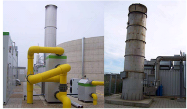
Figura 3.12 Quemadores de biogás [8].
