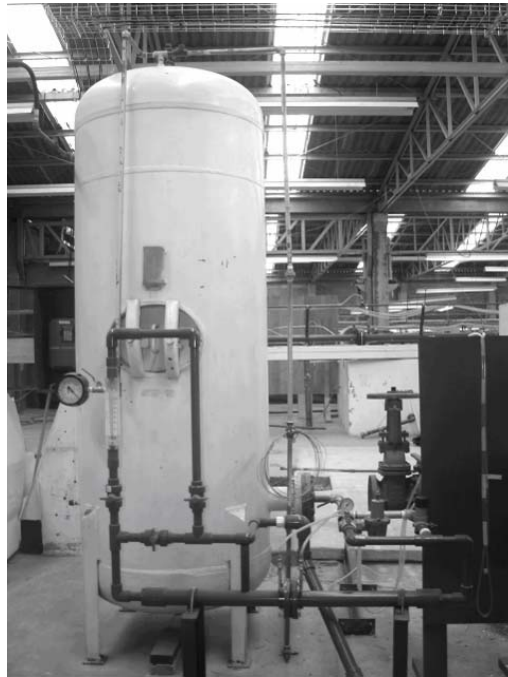
Figura 5.5. Sistema neumático (tanque acumulador y dispositivos de regulación).
