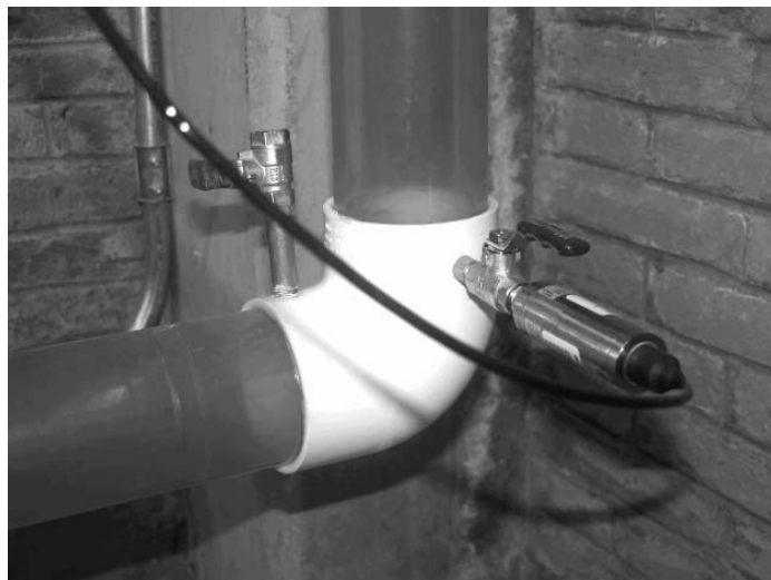
Figura 5.10. Transductores de presión (base del tramo vertical).
