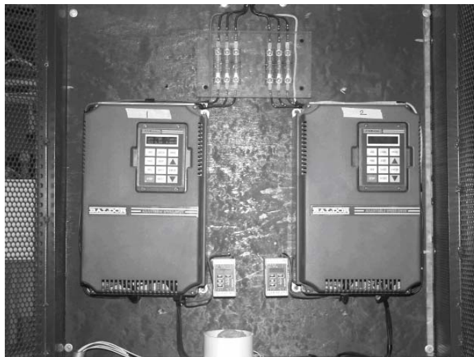
Figura 5.3. Variadores de frecuencia para el control de las bombas.
