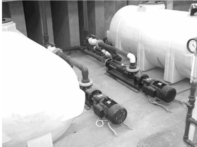
Figura 5.2. Tanques de almacenamiento y bombas de cavidad progresiva.
