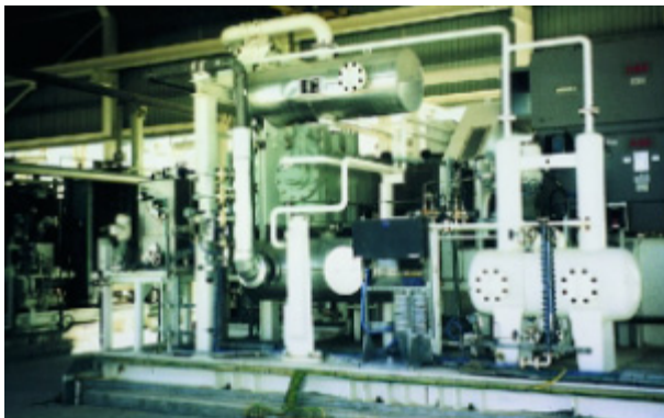
Fig. 5.93 Estación de compresión recíprocante para gas de baja presión.
