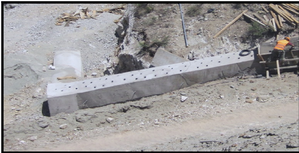
FIGURA 3.11. Sistema decantador drenante existente (imágenes proporcionadas por el departamento de Planeación de Minera La Negra)
