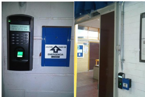
Figura 2.6. Mejoras que se hicieron en los salones (Biométrico, palanca de emergencia e imanes para el cierre de puerta).
