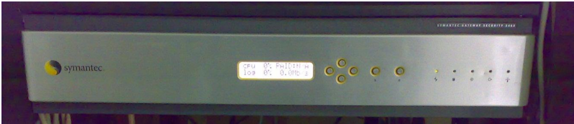
Figura 3.14 Firewall en su estado actual
