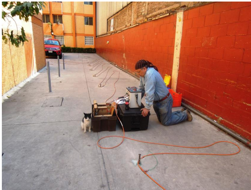
Imagen 7.- Revisando el buen funcionamiento del equipo.
