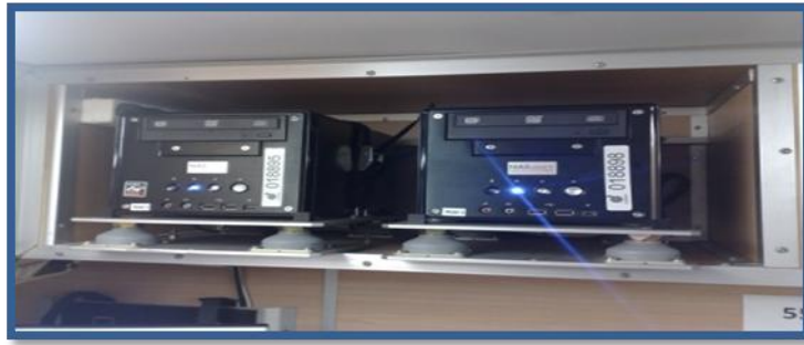
Foto No. 34. Sistema de Almacenamiento NAS
