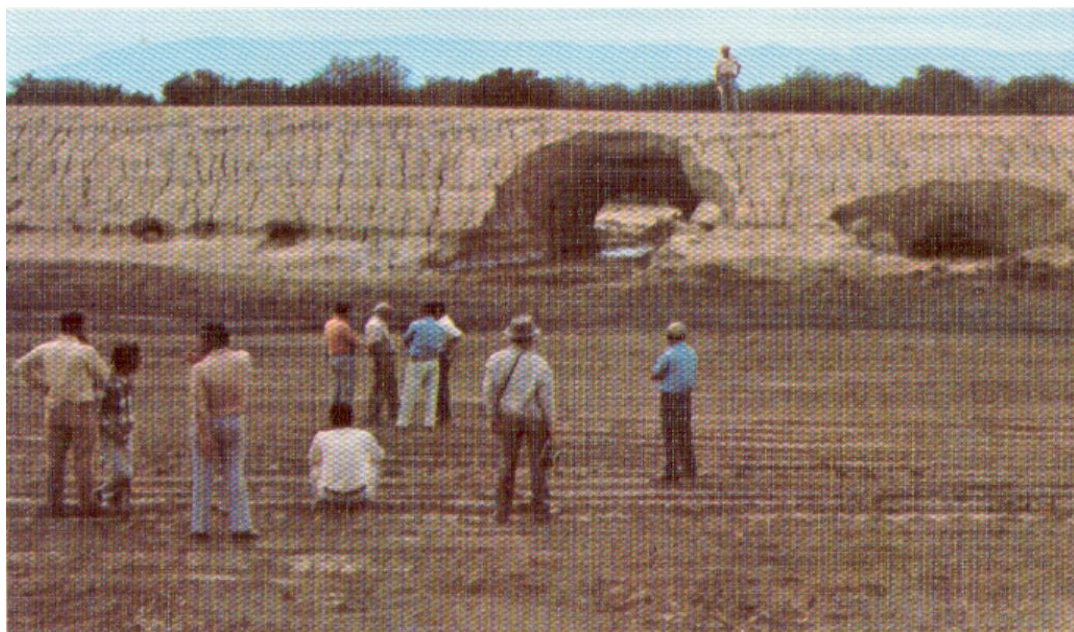
Fotografía 7.1.2. Acercamiento en donde se muestra vista hacia aguas abajo, de algunas de las tubificaciones producidas en la cortina de la presa en el sitio El Sauz. Fuente: CFE.
