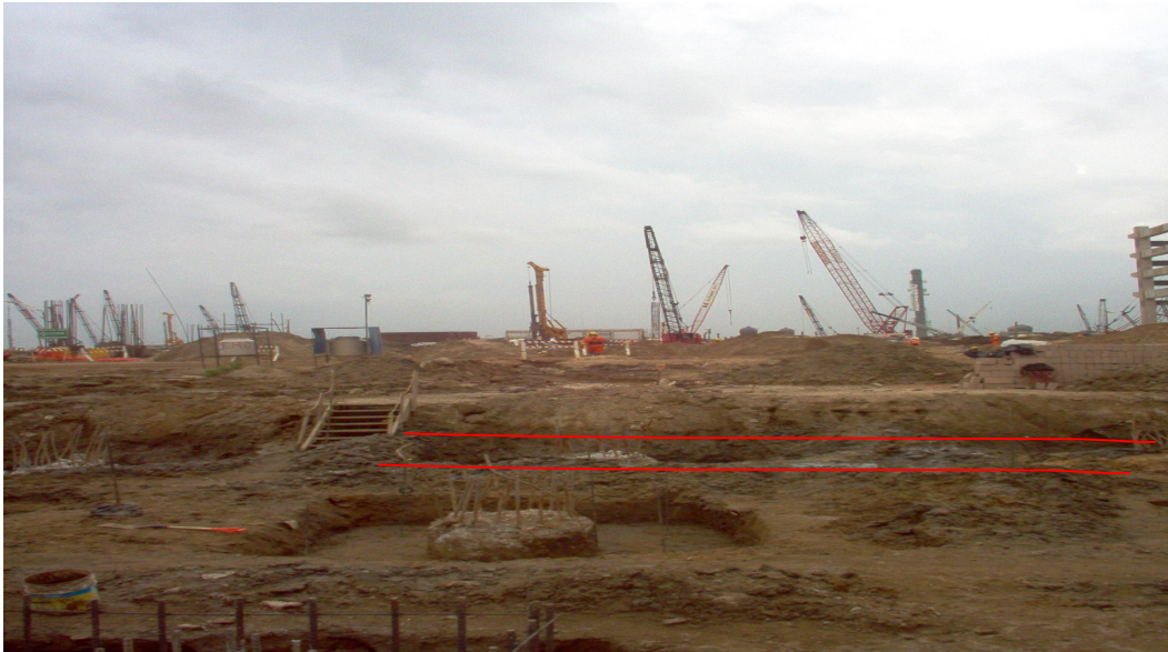
Fotografía 7.2.2. Se muestra el relleno que han colocado sobre el material con materia orgánica formado, el cual presenta intercalaciones de arena y arcilla. Refinería Lázaro Cárdenas.
