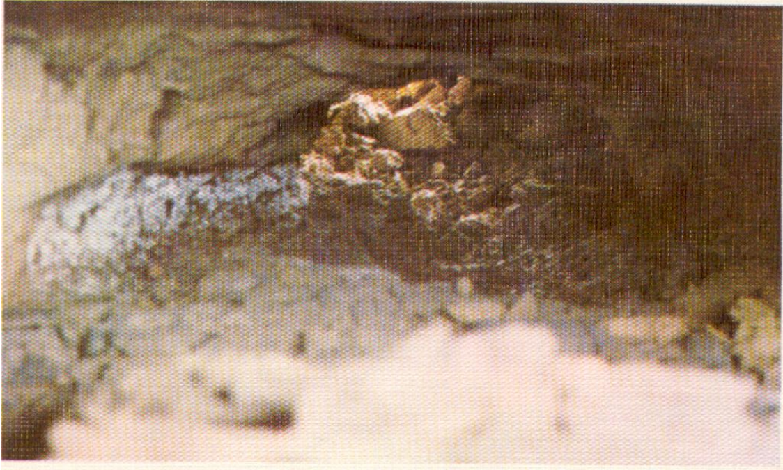
Fotografías 2.7.1 y 2.7.2. Fenómeno de dispersión y tubificación de una obra de contención construida con arcillas dispersivas en el sitio denominado “El Sauz”, estado de Tamaulipas.
