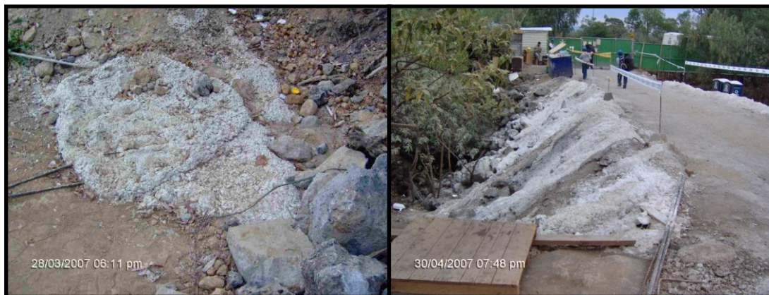
Figura 3.7: Residuo del concreto luego del vaciado de la mezcladora.
