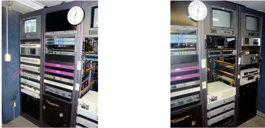
Figura 3-1. En la foto se observan las diferentes máquinas grabadoras y reproductoras como son Betacam SX, SP y XDCAM, así como también los controles del Kaleido y los sincronizadores.
