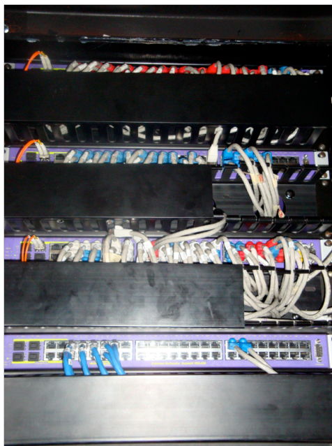
Figura 5-3. Switch marca Extreme con velocidad de transferencia de 10/100/1000 Mb/s.
