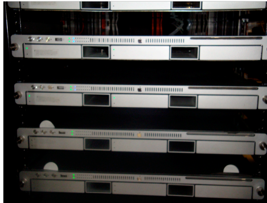
Figura 5-1. Servidores Xserve vista frontal.
