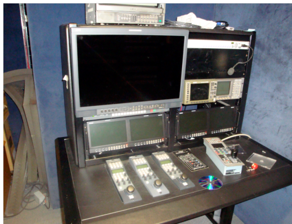
Figura 3-2 Unidad de control de cámaras (CCU), auxiliado por un monitor de imagen por cámara y un monitor forma de onda para revisar que todos los niveles de video esten conforme a la norma NTSC.
