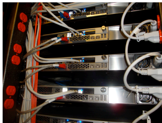
Figura 5-2. Vista trasera de los servidores Xserve, se puede observar las dos conexiones de red que van a ser utilizadas así como las conexiones de tarjeta de fibra óptica necesarias para operar dentro del flujo del sistema tapeless.
