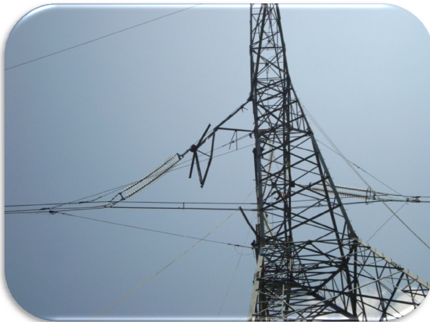
Figura 92. Vista de la T-494, en la cual se observa la trabe dañada, condiciones similares a la T-494
