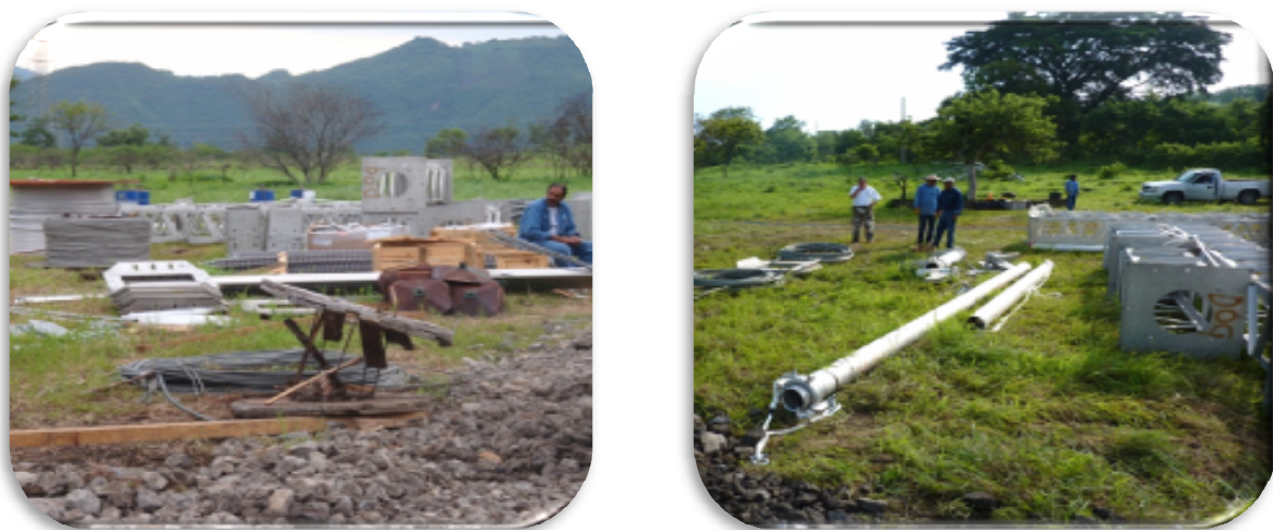
Figura 119. Habilitación del Centro de Acopio "El Caballito" ubicado a 4 km de la torre colapsada
