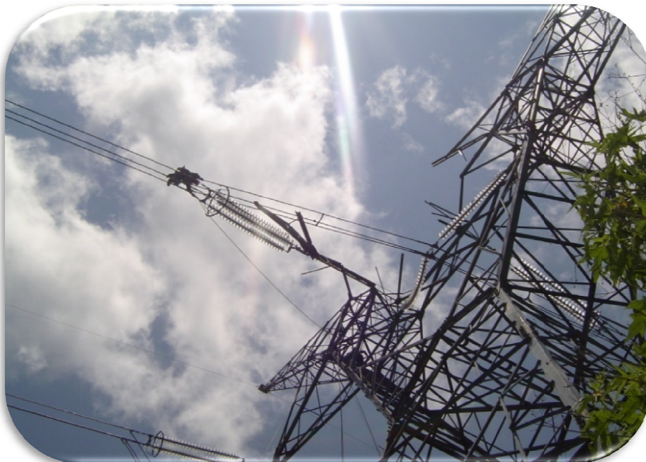
Figura 90. Vista de la T-494, en la cual se observa la trabe dañada.
