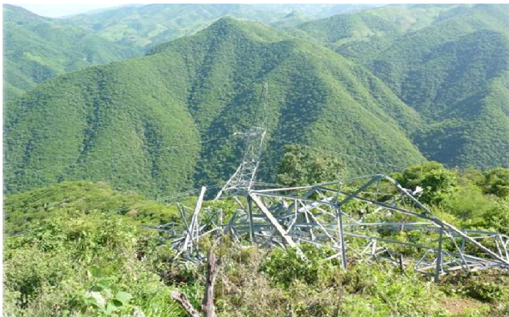
Figura 88. Vista de la T-495 colapsada
