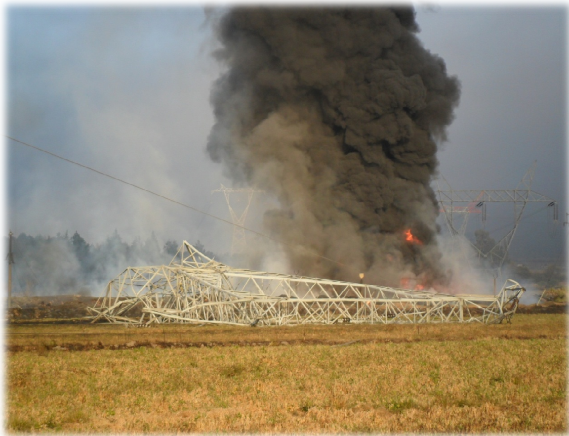
Figura 122. Vista de la T-64 colapsada
