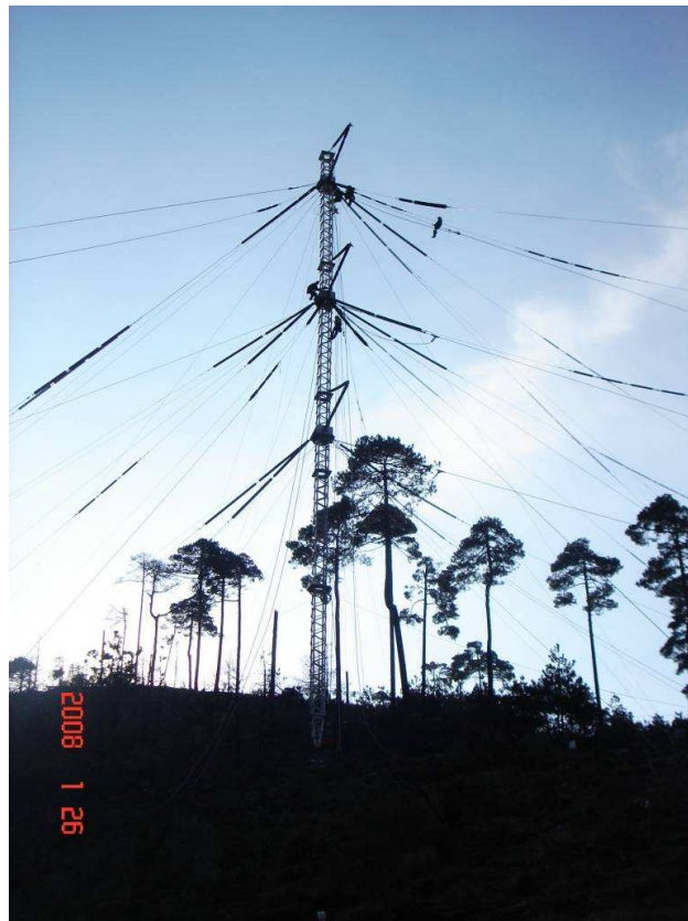
Figura 81. Vista final de la T-50, donde se observa el aislamiento sintético de las retenidas.
