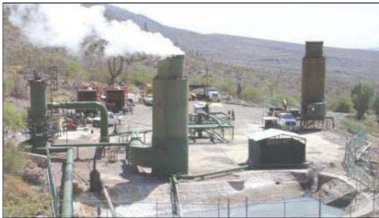
Figura 2.9 Central geotermoeléctrica Las Tres Vírgenes. [2]
