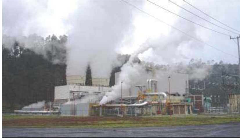
Figura 2.7 Central geotermoelectrica Los Azufres. [2]
