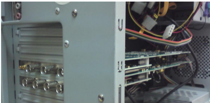
Figura A.1.5 Vista del interior del gabinete y el panel de conexión de las tarjetas.
