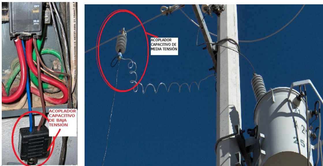
Fig. 2.2 Acoplador capacitivo de baja y media tensión
