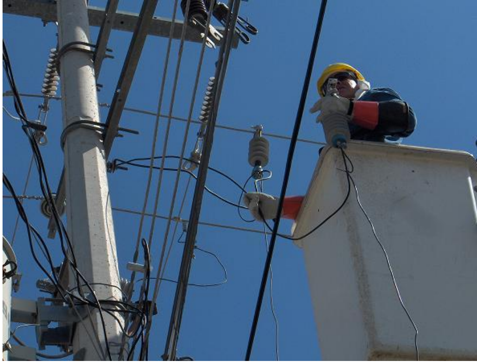
Fig. A.4 Instalación de acopladores capacitivos en media tensión
