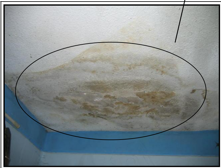
Fotografía 13. Véase el problema serio de humedad a causa de la falta de mantenimiento preventivo de la impermeabilización.
