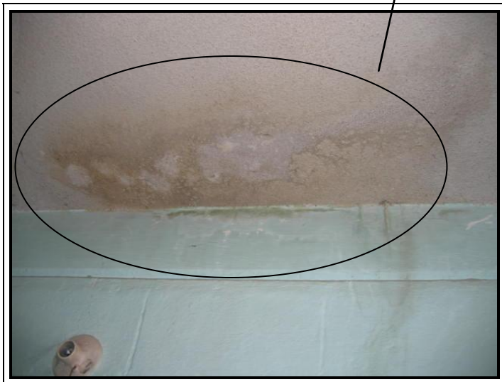
Fotografía 14. En esta imagen se ve otro ejemplo de los imperfectos ocasionados por la falta de mantenimiento preventivo, teniendo que recurrir al mantenimiento correctivo para reparar el daño.
