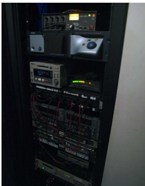
2.V Rack de recepción de material externo
