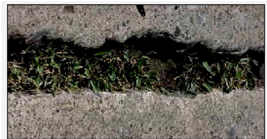
Junta con acumulación de materia orgánica.
