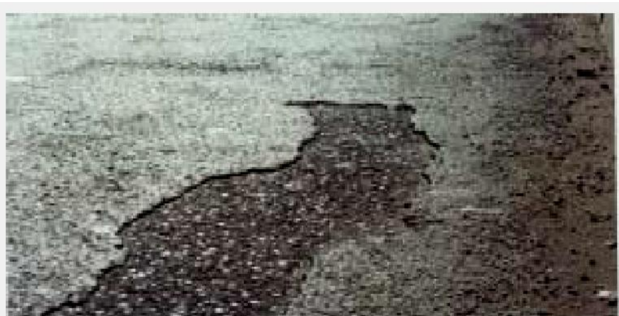
Peladura formando cavidades.
