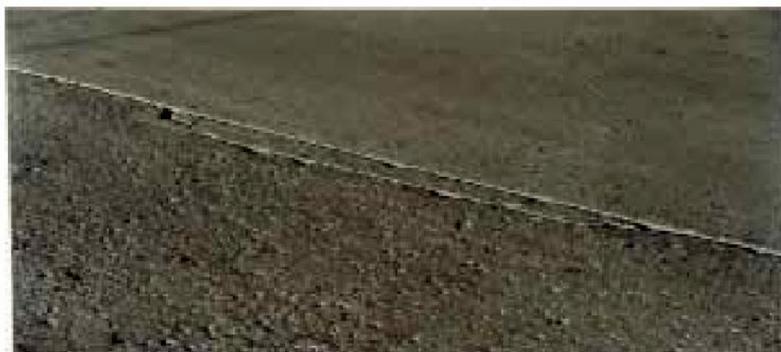
Fisura por mal mantenimiento de juntas.
