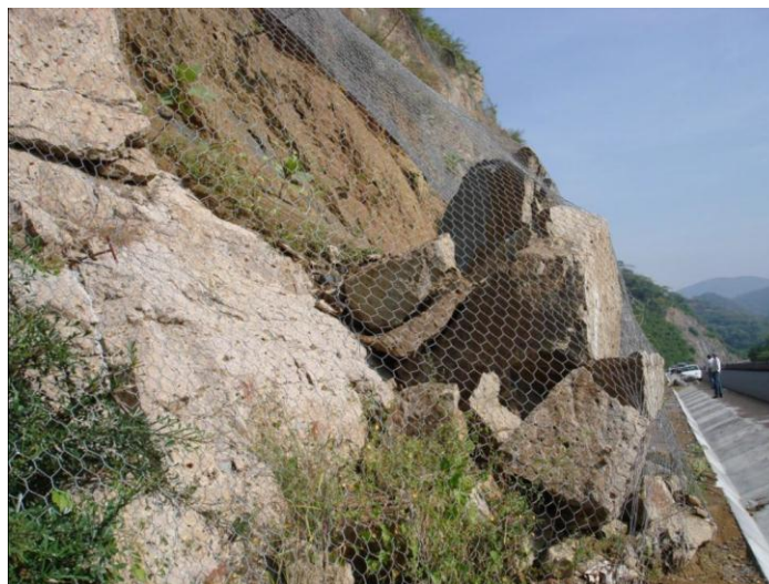
Figura 2.24 Control de caídas de rocas utilizando mallas ancladas.
