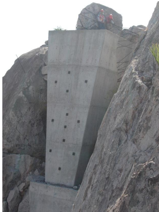
Figura 5.1 Estabilización de roca en la C.H. Huites, a base de un dique que concreto. 42
