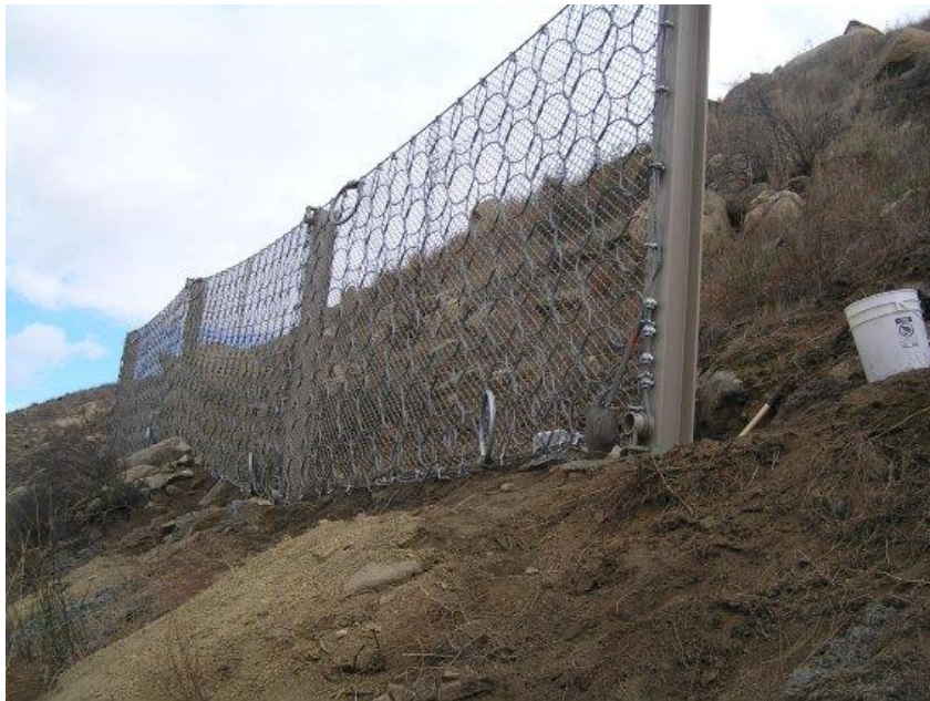
Figura 3.26 Finalización de la construcción de una barrera dinámica en el lago Elsinore, California. 41
