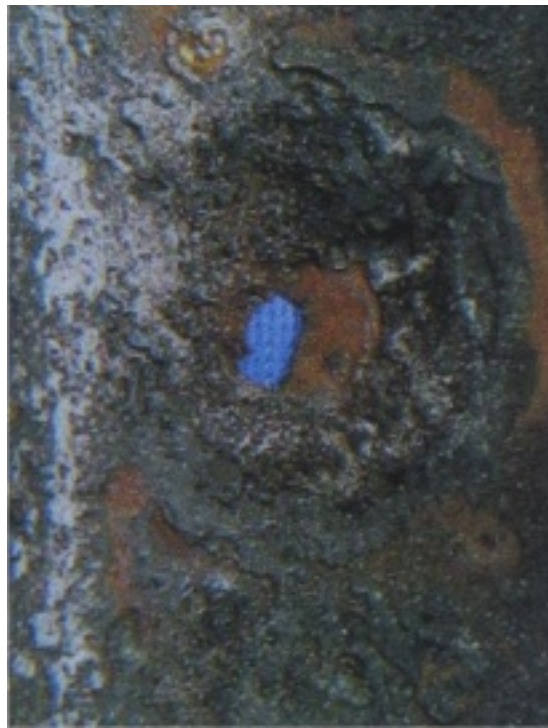
Figura 4.2 Tubo de acero corroído (Díaz et al., 2010)
