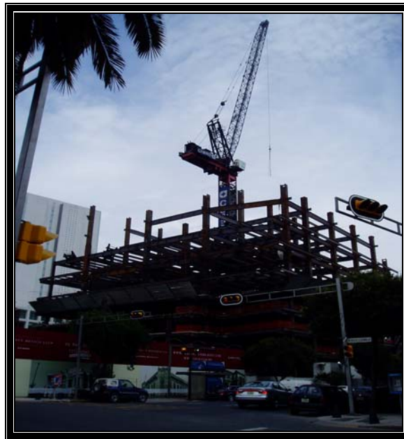
Figura 2.11. Acero estructural utilizado en construcciones de edificación Fuente: Elaborada por la autora
