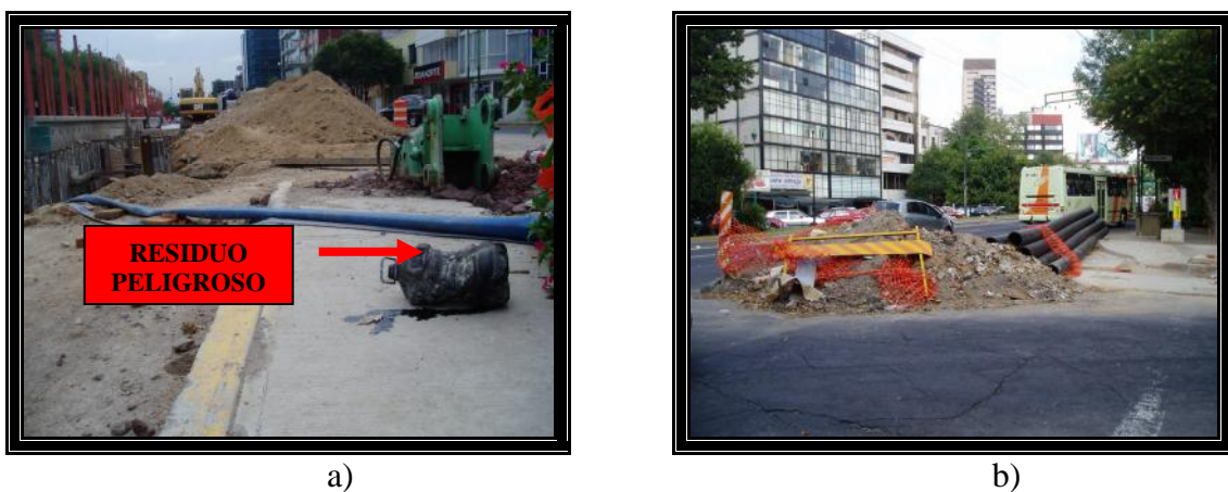
Figura 5.6. Residuos en obras de construcción, a) Residuos peligrosos, b) Residuos de manejo especial Fuente: Elaborada por la autora
