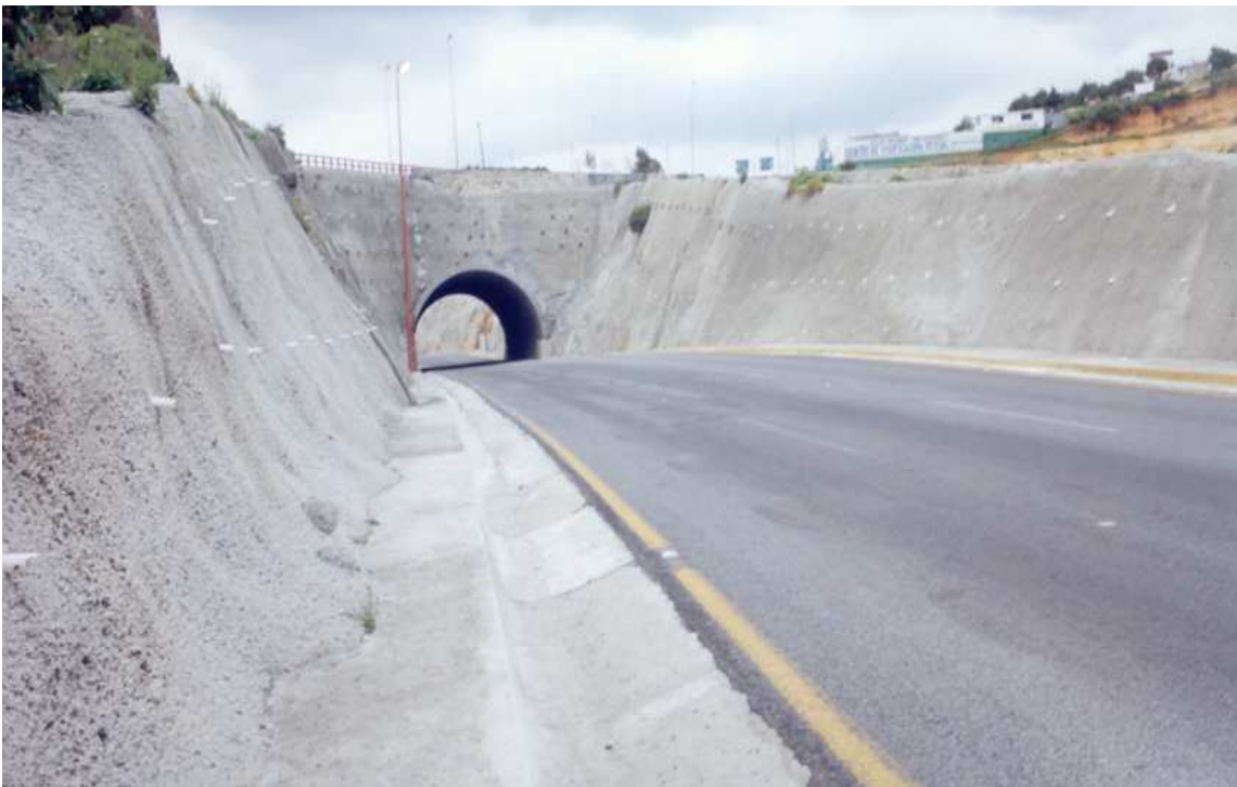
Imagen 32. Salida del túnel mediante el portal oriente. En donde se realizaron los trabajos de anclaje Y drenaje correspondiente a los taludes sobroyacente y adyacente al mismo portal, así como el revestimiento respectivo.
