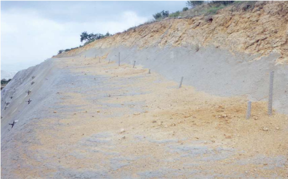
Imagen 33. Se muestra el revestimiento realizado mediante concreto lanzado, en donde como primera etapa se colocó malla electrosoldada para combatir los posibles caídos en la zona del portal poniente. Se observa a su vez la colocación de varillas de 1" (que se encuentran por su parte empotradas mediante la realización de barrenos en la roca) para sostener el tendido de malla.
