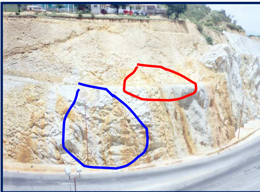
Imagen 22. Diaclasas presentes en la roca existente en el túnel.
