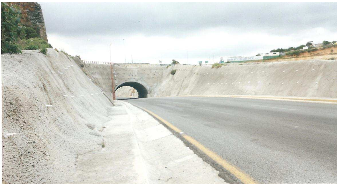
Imagen 36. Funcionamiento de los dispositivos de drenaje o más propiamente subdrenaje. Desalojo pluvial en el talud del portal oriente. Condición que nos ayuda a mitigar los esfuerzos de poro provocados por el exceso de agua en los tiempos de lluvia.
