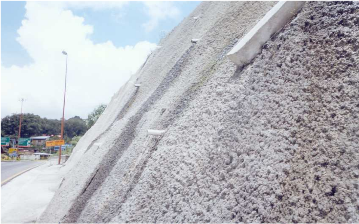
Imagen 35. Ejemplo del cumplimiento de las dos requisitos contradictorios que párrafos arriba se mencionaron: en donde hay que desalojar la mayor cantidad de agua perjudicial para el material, sin que a su vez se provoque una erosión de dicho material que traiga como consecuencia el arrastre de finos que nos reduzcan la resistencia al esfuerzo cortante de la toba.
