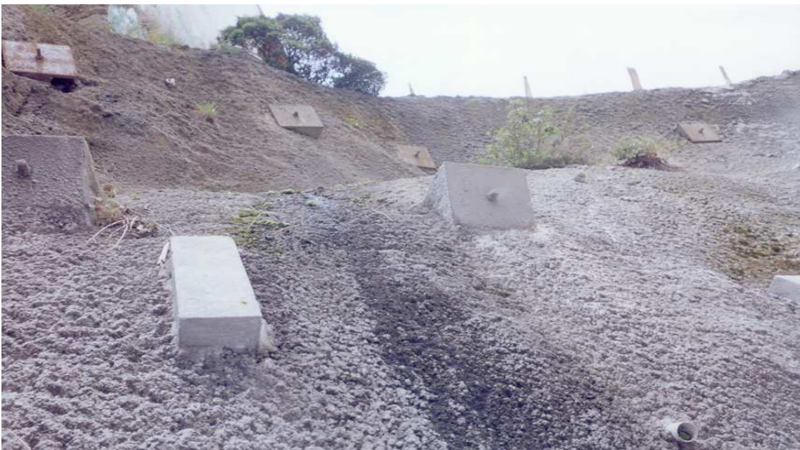
Imagen 30. Se observa la aplicación de la función que desempeñan las anclas, en cada uno de los taludes por estabilizar. Las anclas colocadas son del tipo activas o de tensión y se trata de un talud situado a la salida del túnel, en el portal oriente.
