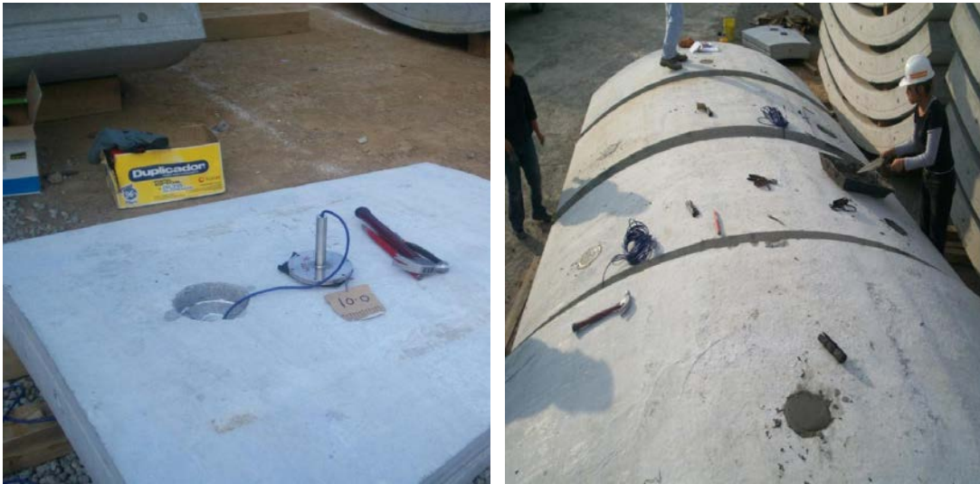
Fig. 4.31 Celdas de presión instaladas dentro de las dovelas que conformarán el soporte del túnel (imágenes tomadas de la Ref. 19).
