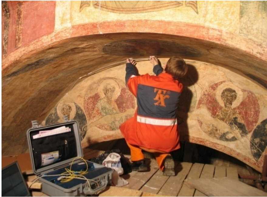
Fig. 4.40 Instalación de sensores, Catedral de la Anunciación, Kremlin, Rusia (imagen tomada de la Ref.3 de Internet).
