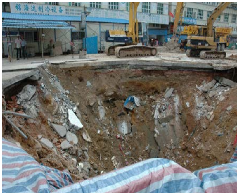
Fig. 4.28 Efecto en superficie del colapso de un túnel (imagen tomada de internet).
