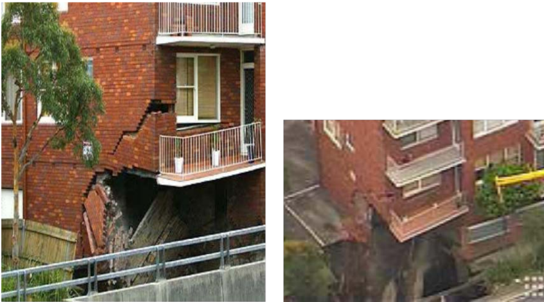
Fig. 4.27 Cráter de 10m x 10m debido al colapso de un túnel de ventilación, Australia, 2005. Imagen tomada de la Ref.11 Internet, pp 112-115).
