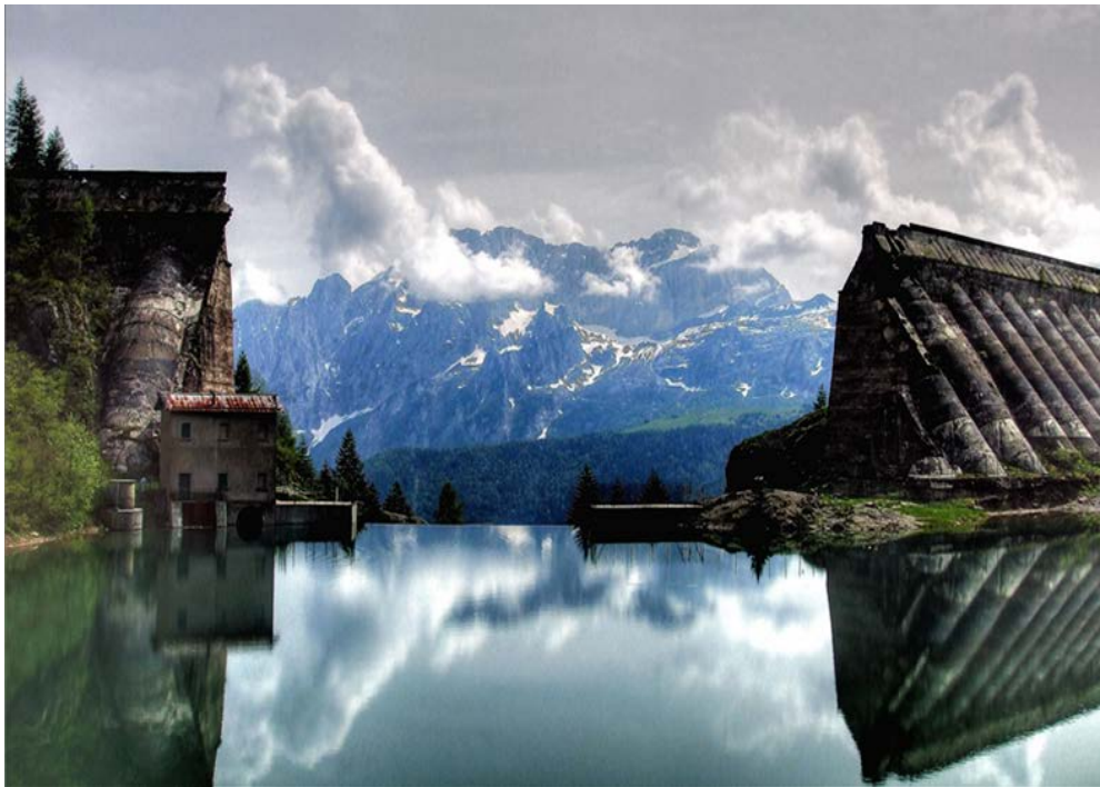
Fig. 4.12 Colapso parcial de la presa Pian del Gleno, Valle de Scalva, Italia (imagen tomada de la Ref.28).
