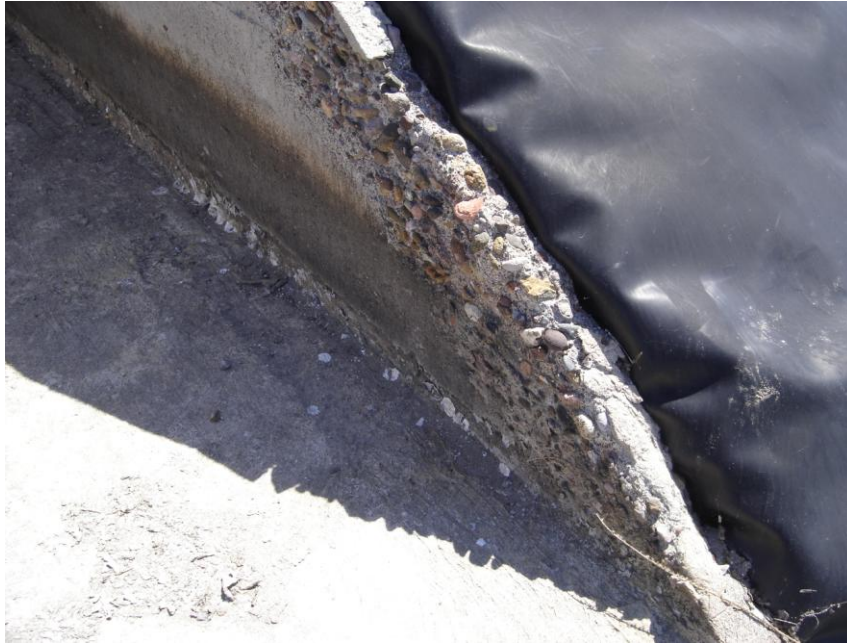
Figura 79. Deterioro en alguna de las estructuras de concreto para la conducción del agua a los estanques.
