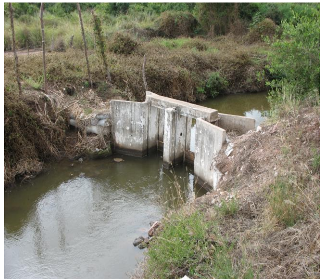
Figura 47. Estructura para el control del agua.
