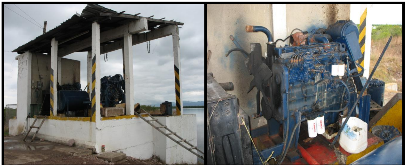
Figura 60. Estación de bombeo y detalle de un motor de bomba diesel.
