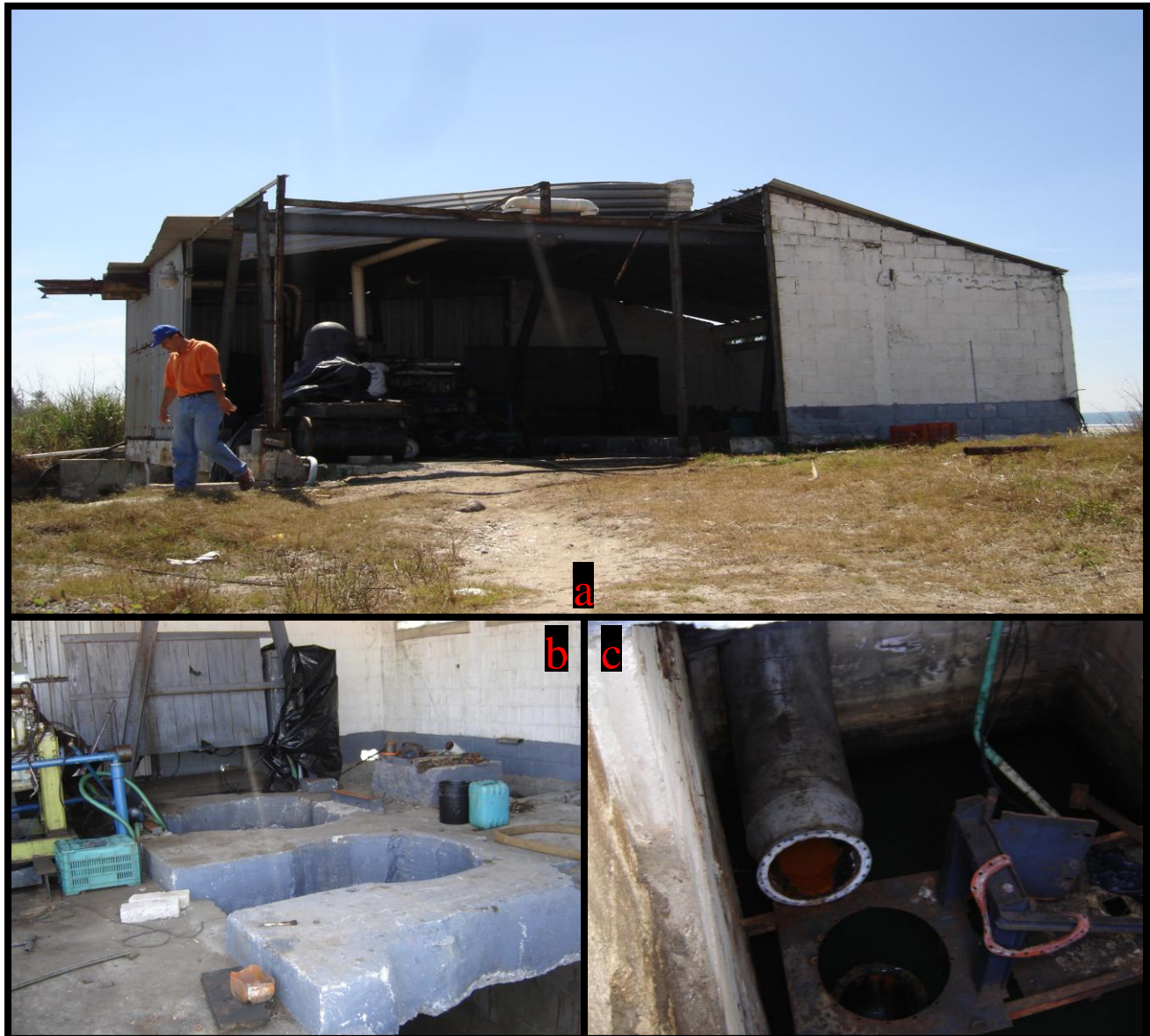
Figura 84. Estación de bombeo: a) vista externa de la estación de bombeo, b) y c) vistas del cárcamo de bombeo.
