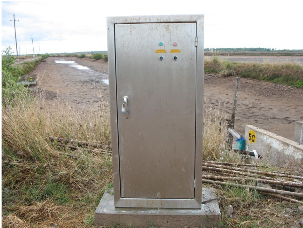
Figura 66. Tableros de control para los aireadores.
