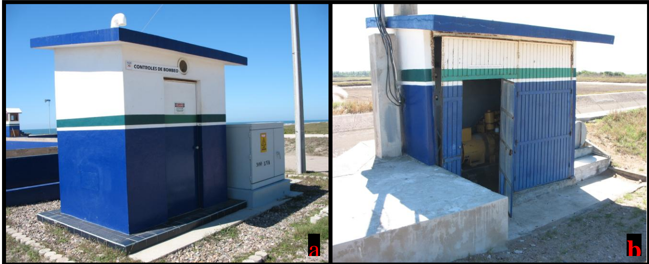
Figura 39. Equipamiento para la operación: a) centro de control de bombeo y transformador de 300 kVa, b) caseta con generador de emergencia.
