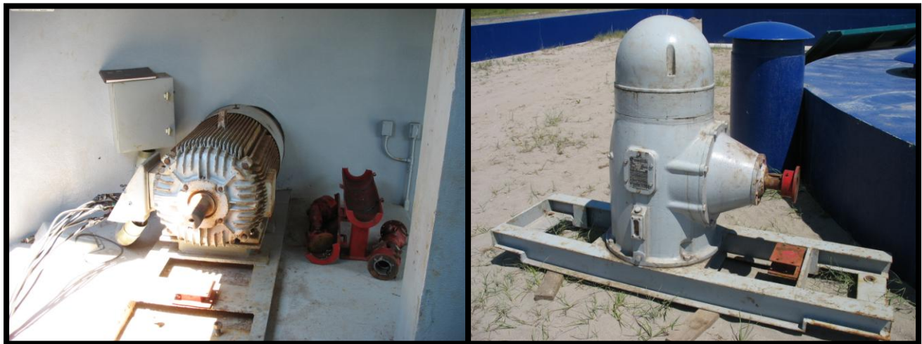
Figura 38. Equipo de bombeo eléctrico.
