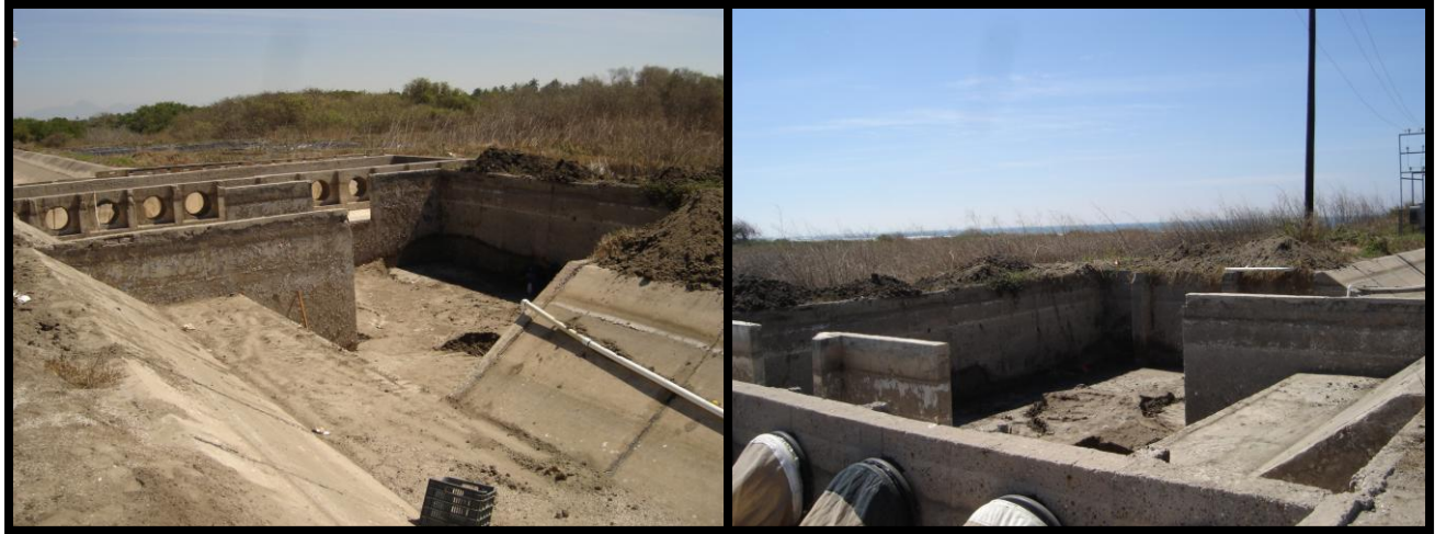
Figura 75. Caja de sedimentación.
