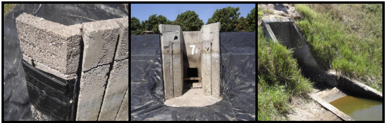
Figura 82. Deterioro en estructuras de salida.
