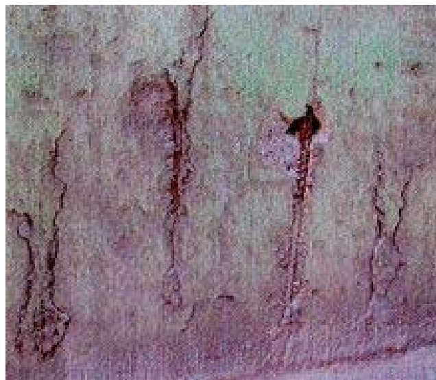
Figura 3.4 Corrosión incipiente del acero de refuerzo
