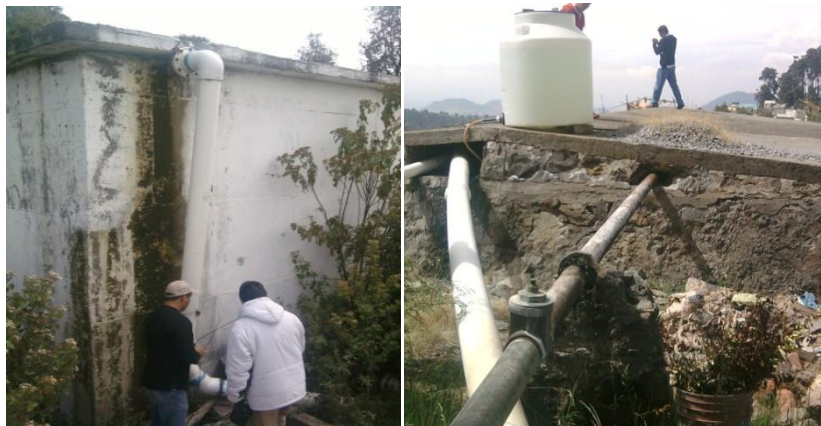
Figuras 2.4 y 2.5. Tanques de regulación de agua potable.
