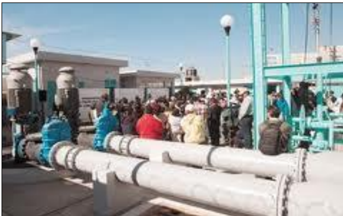
Ilustración 16 Planta de bombeo ex lienzo charro.
