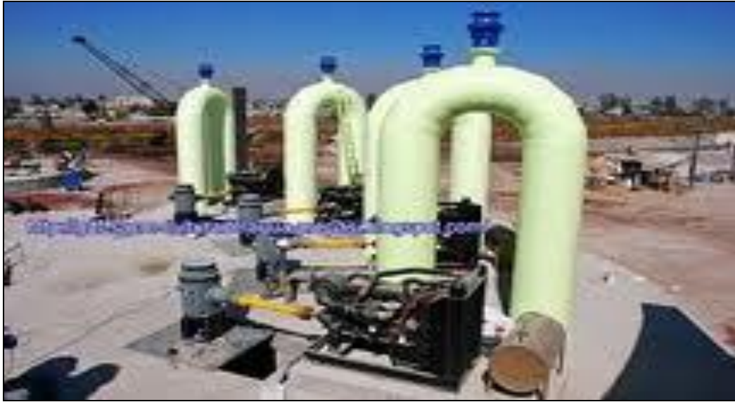
Ilustración 21 Planta de bombeo Casa Colorada.
