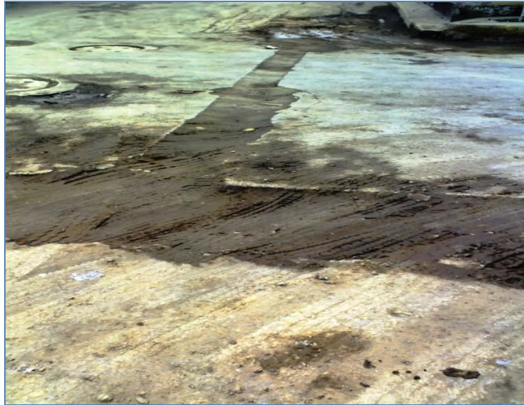
Ilustración 28 ZANJAS SATURADAS DE AGUA DE LLUVIA.
