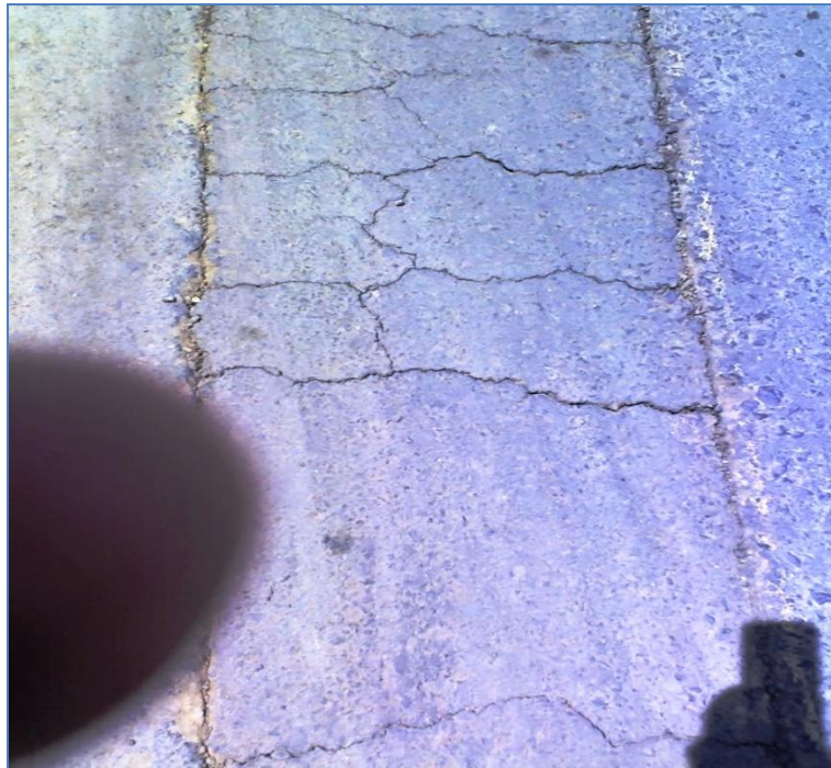
Ilustración 32 SE MUESTRAN AGRIETAMIENTOS EN LA ZONA DE HIDALGO, POR MALA COMPACTACIÓN.
