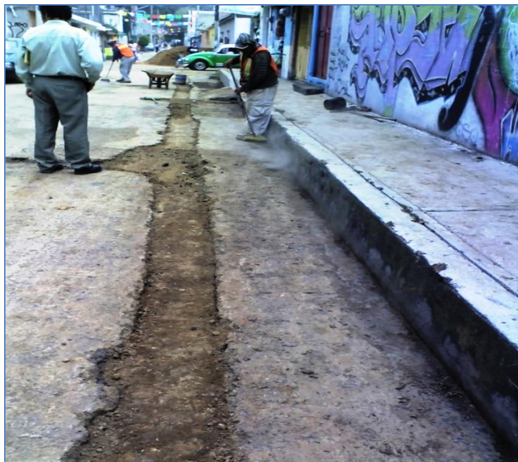
Ilustración 35 LAS DIMENSIONES DE LA ZANJA AUMENTARON POR LO FRÁGIL DEL SUELO EN SEVERINO CENICEROS.
