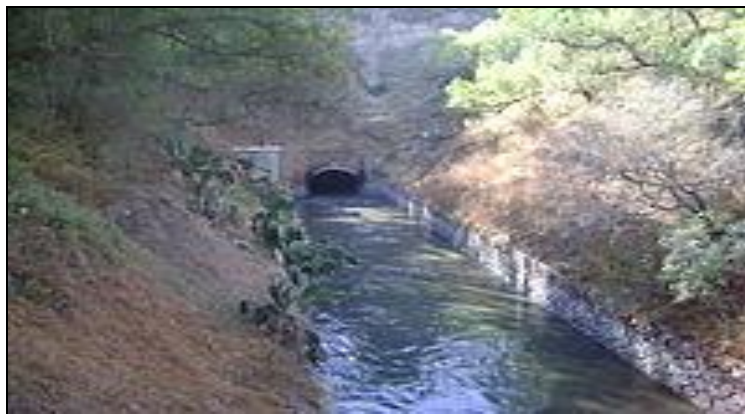
Ilustración 1 el túnel del canal de desagüe de la ciudad de México, en el tajo de Tequixquiac
