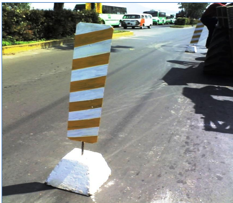
Ilustración 29 FALTABA CINTA PREVENTIVA, EN ZONA DE TRABAJO EN LA AV. TLÁHUAC-TULYEHUALCO.
