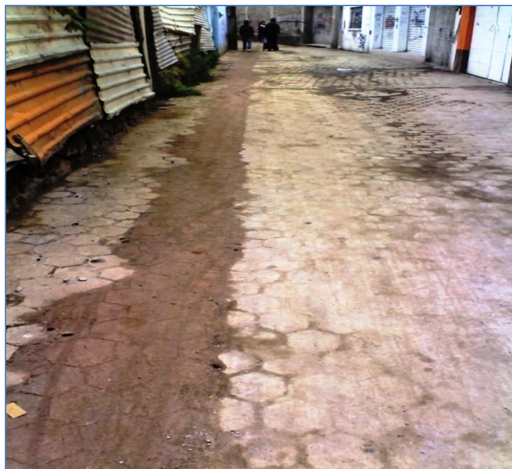
Ilustración 31 SE ACORDÓ MEZCLA DE CEMENTO EN EL TRAMO DE ADOQUÍN EN SAN JUAN.
