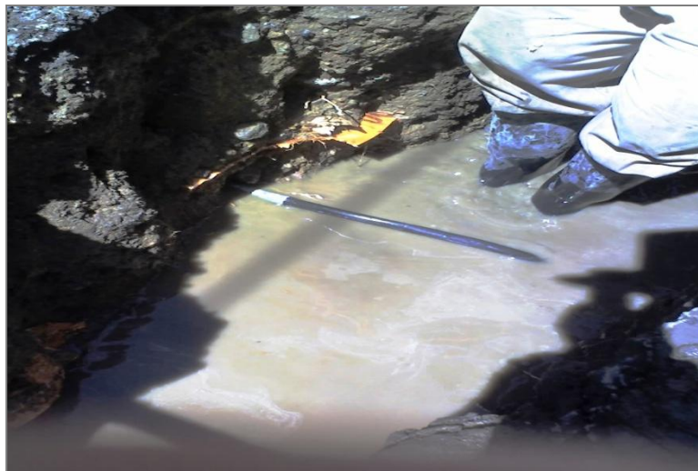
Ilustración 42 FUGA EN SEVERINO CENICEROS.
