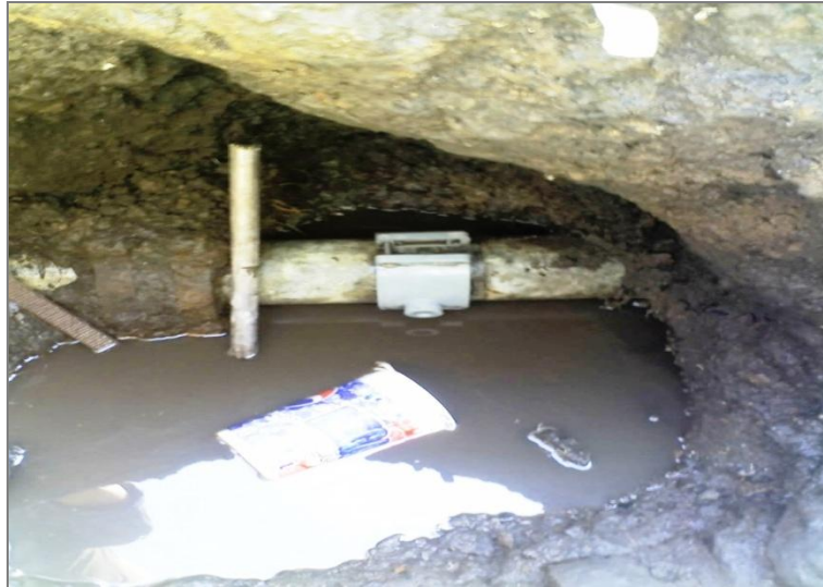
Ilustración 41 FUGA EN HIDALGO.
