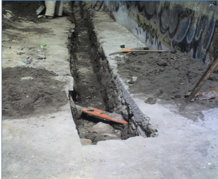
Ilustración 30 TRAMO DONDE SE ENCUENTRA TUBERÍA DE 45 CM, 4 METROS ANTES DEL QUIEBRE EN SAN JUAN.
