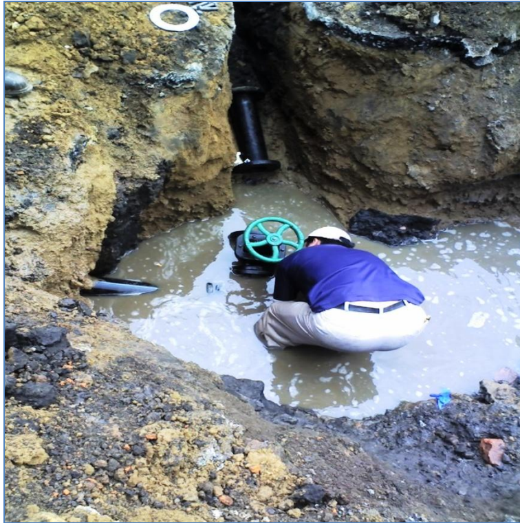
Ilustración 38 CAJA DE VÁLVULAS EN GALEANA.
