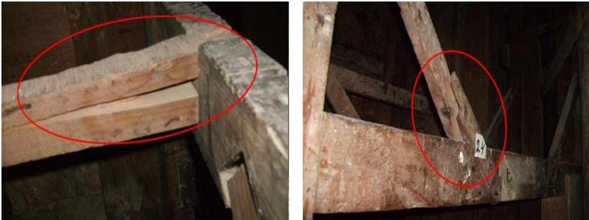
Figura 41. Elementos estructurales fracturados
