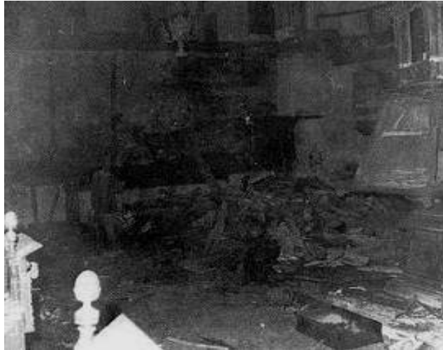
Figura 32. Vista del coro, después del incendio de 1967
