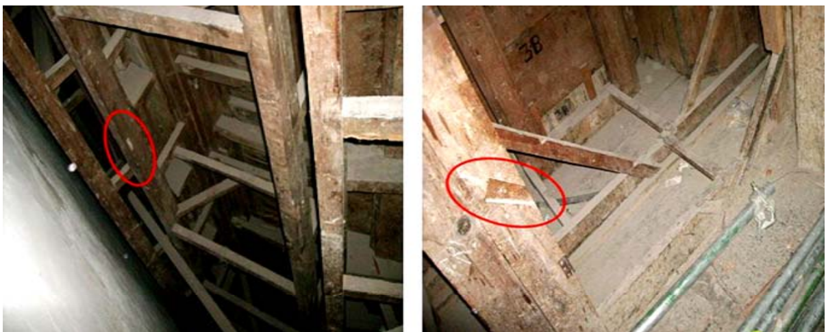
Figura 43. Elementos estructurales faltantes
