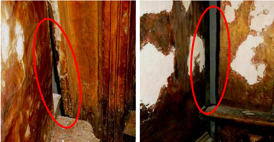
Figura 36. El hundimiento diferencial de la catedral provocó fracturas en el retablo
