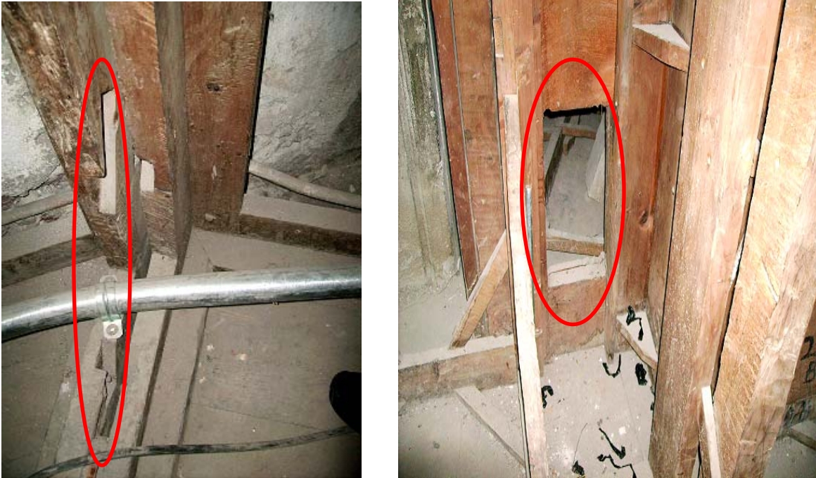
Figura 39. Rotura de viga en elemento secundario y abertura de ventana en elemento primario para el paso de la instalación eléctrica
