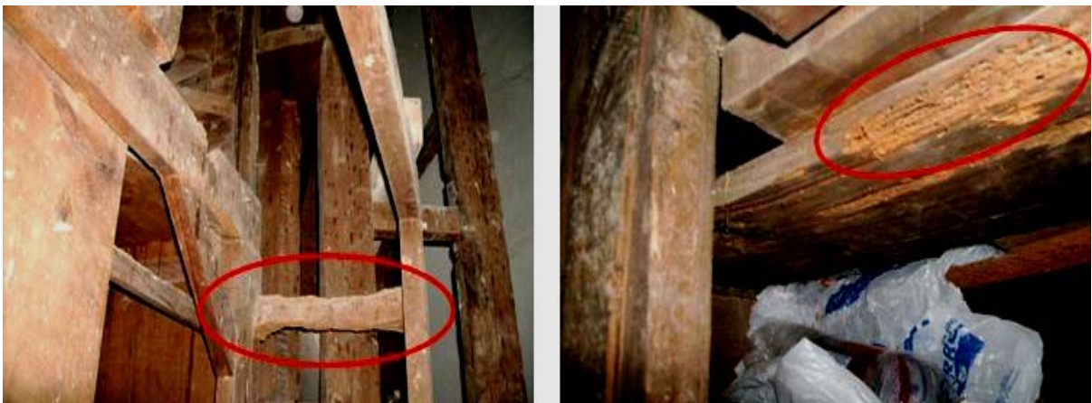
Figura 42. Deterioros en elementos estructurales causados por insectos xilófagos
