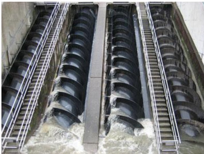
Figura 1.7 Bombas de tornillo
