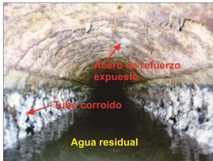
Figura 2.3 Tubería de concreto corroída con el acero de refuerzo expuesto.
