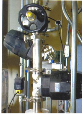
Figura 1.9.1 Sistema de agua purificada construida en tubería en acero inoxidable, con válvula a 45°
