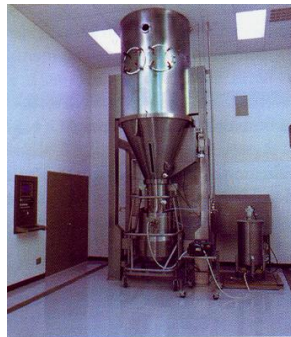
Figura. 1.9.2 Equipo secador de lecho fluido que muestra el área de proceso, los componentes mecánicos para mantenimiento se encuentran en el área técnica (sobre plafón)
