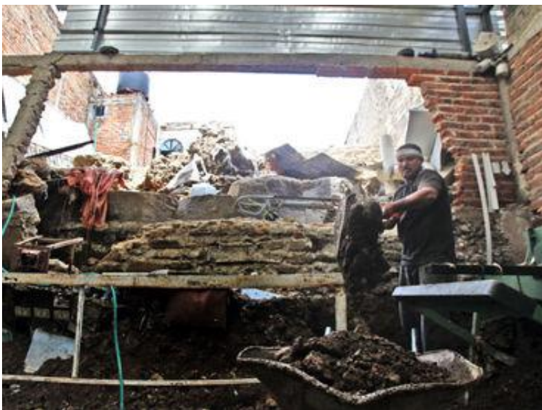
Una de las casas destruidas por la mega fuga en la colonia Balcones de la Cantera, Municipio de Zapopan. Periódico El Informador, mayo 2011.
