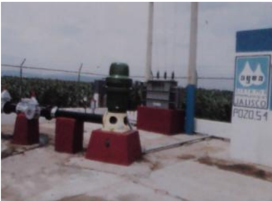
Pozo N° 54. Sistema Tesistán
