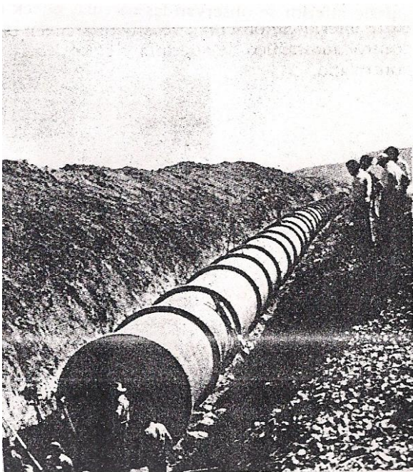
Vista de conjunto que muestra los tramos de tubería del acueducto, antes de ser rellenados.
