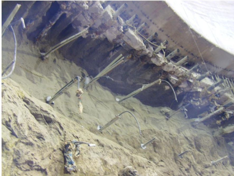
Foto 4. Bóveda paraguas y anclas de fibra de vidrio en galería de montaje
