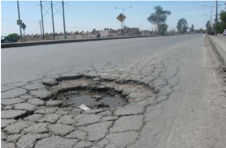
Fig.I.5.- Grietas, baches y desgranamiento de un pavimento (Fuente: SCT).
