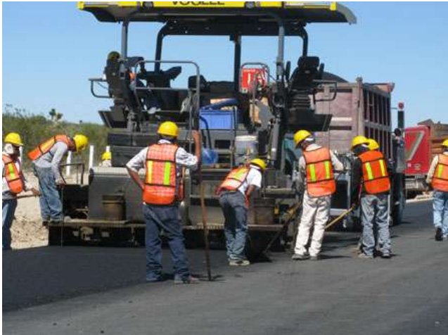
Fig.I.2.- Trabajos de conservación de carreteras mediante tendido de sobre carpeta asfáltica (Fuente: SCT).
