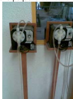
Figura 27: Bombas dosificadoras planta desalinizadora piloto
