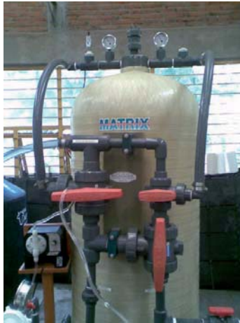
Figura 23: Filtro Multimedia planta desalinizadora piloto
