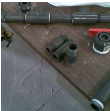
Figura 33: Accesorios y tubería de la planta desalinizadora
