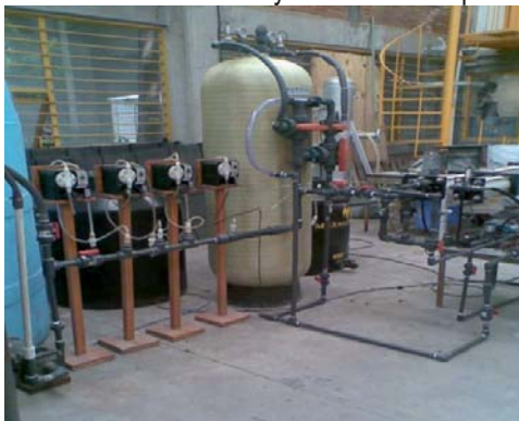
Figura 40: Planta desalinizadora piloto instalada
