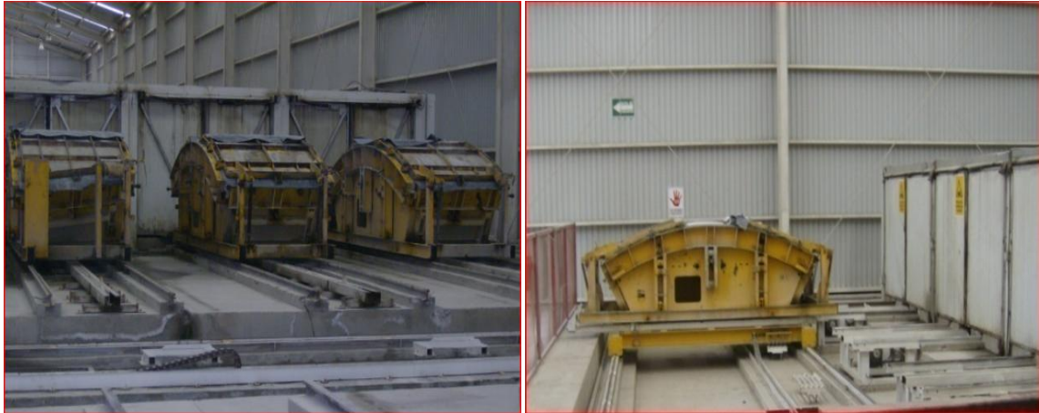
Entrada y salida de moldes de la cámara de curado
