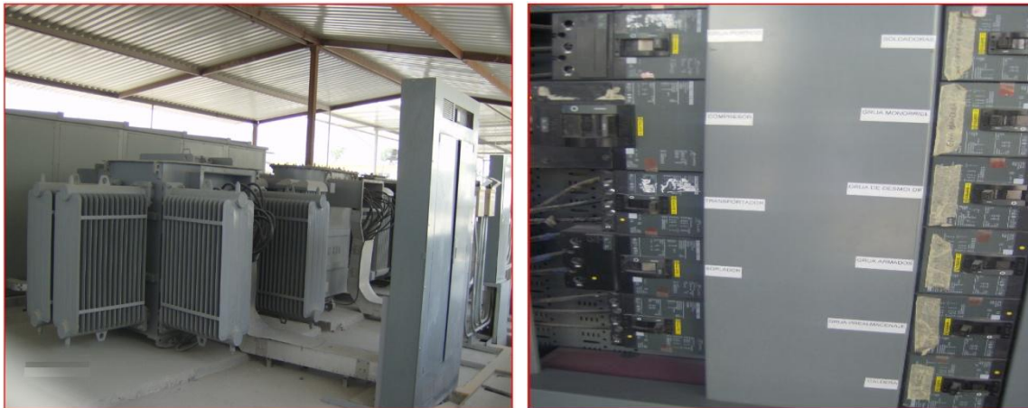
Transformadores y tablero electrico
