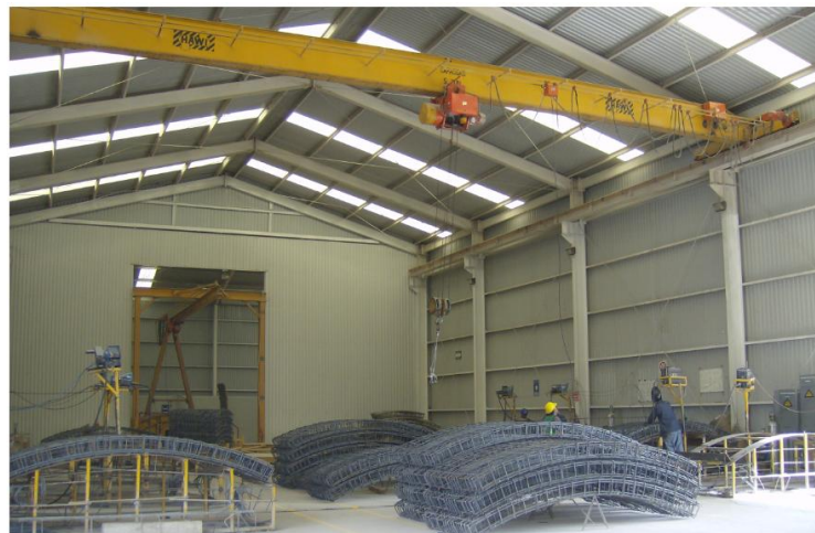
Grúa viajera tipo monopunte con capacidad para 5 toneladas de la marca HAWI. Utilizada para trasladar el acero de la dovela procedente de las mesas de habilitado, hacia la mesa giratoria
