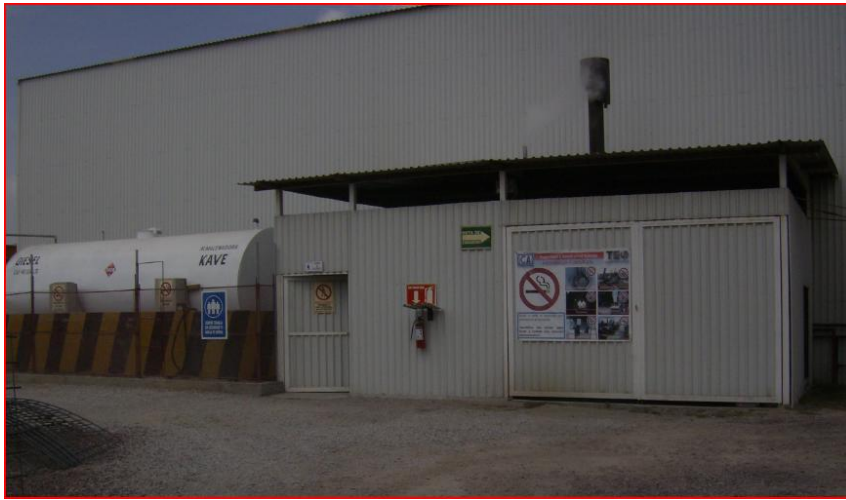
Cuarto de caldera
