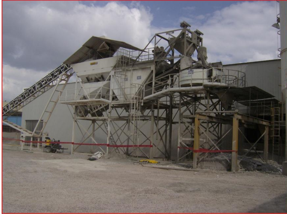
Planta móvil para la fabricación de concreto
