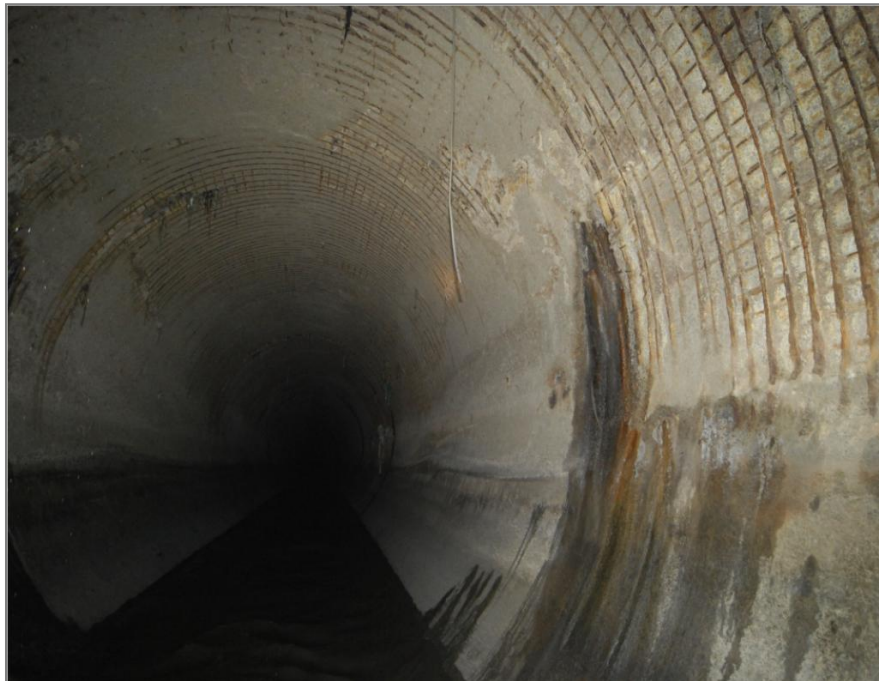
Figura 5.- Estado actual del Túnel Emisor Central, componente principal del sistema de Drenaje Profundo. En la fotografía se alcanzan a ver las varillas de refuerzo expuestas con un cierto nivel de corrosión, desconchamientos diversos en la superficie de concreto y filtraciones. El incremento en la rugosidad de las paredes debido a estos fenómenos afecta la capacidad de desagüe, ya que la velocidad del flujo disminuye.
